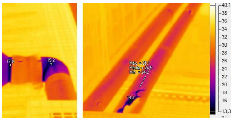
Figura 5.3: Registo termográfico das condutas de água fria dos chillers.
