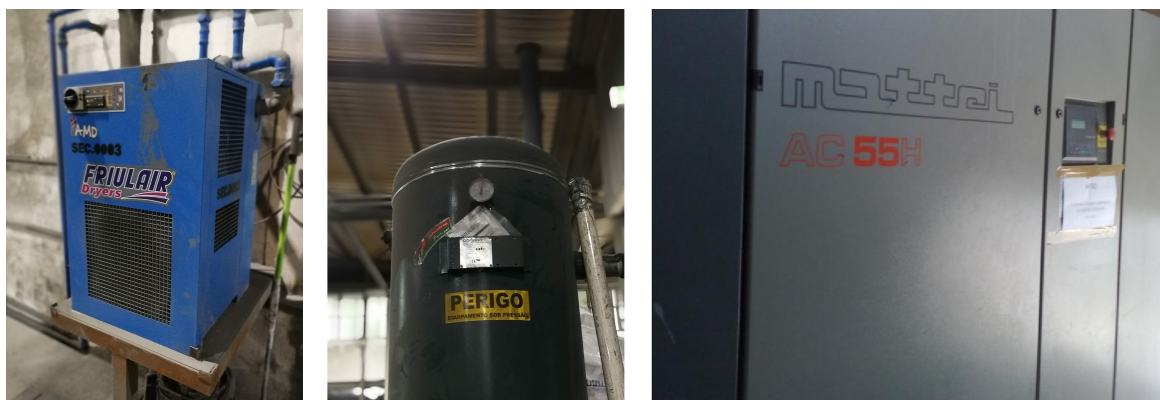
Figura 4.10: Secador, depósito de ar comprimido e compressor de serviço.
