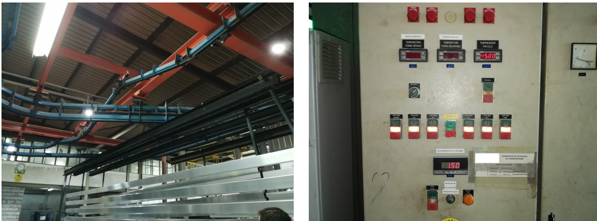
Figura 4.8: Transportadora e quadro de controlo da Lacagem.
