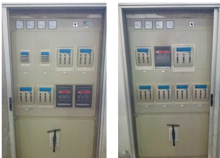
Figura 4.21: Quadros Gerais de Baixa Tensão 1 e 2 - QGBT 1 à direita e QGBT 2 à esquerda.
