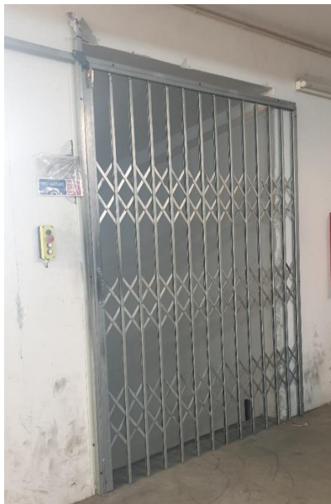
Figura 12 - Elevador no armazém da Sun City Ibérica
