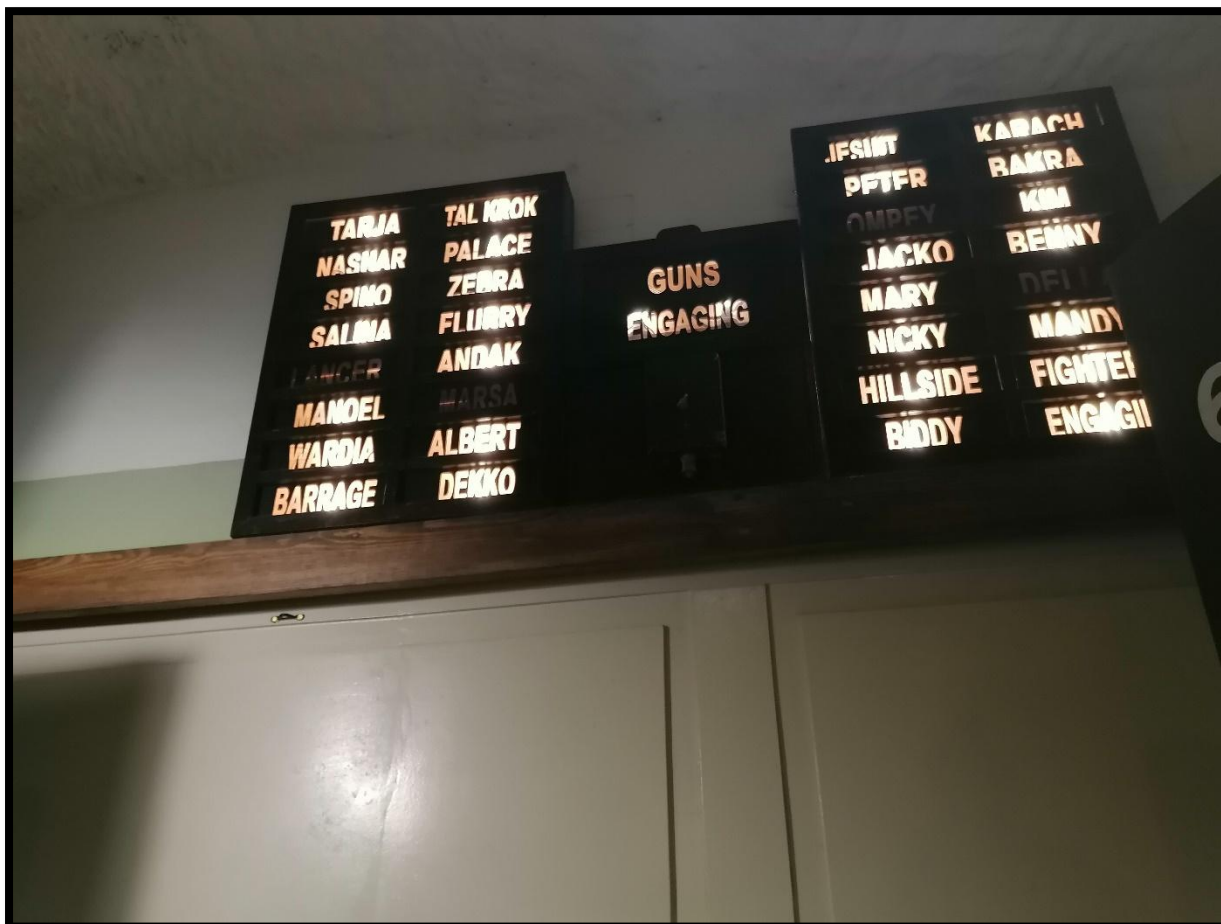
Fig. 337 Quadro de Luz Central
