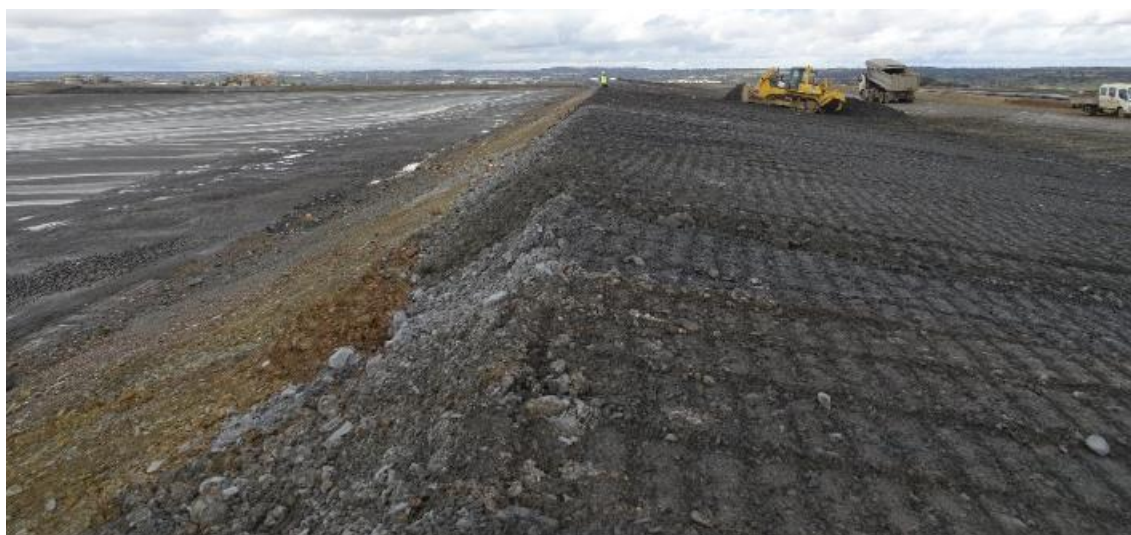
Figura 53. Aplicação de escombro na construção de cobertura e berma perimetral de confinamento.
