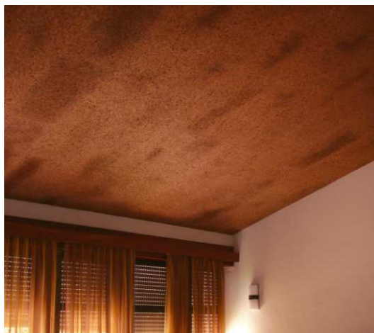
Figura 21 - Revestimento de teto com face à vista de aglomerado composto de cortiça
