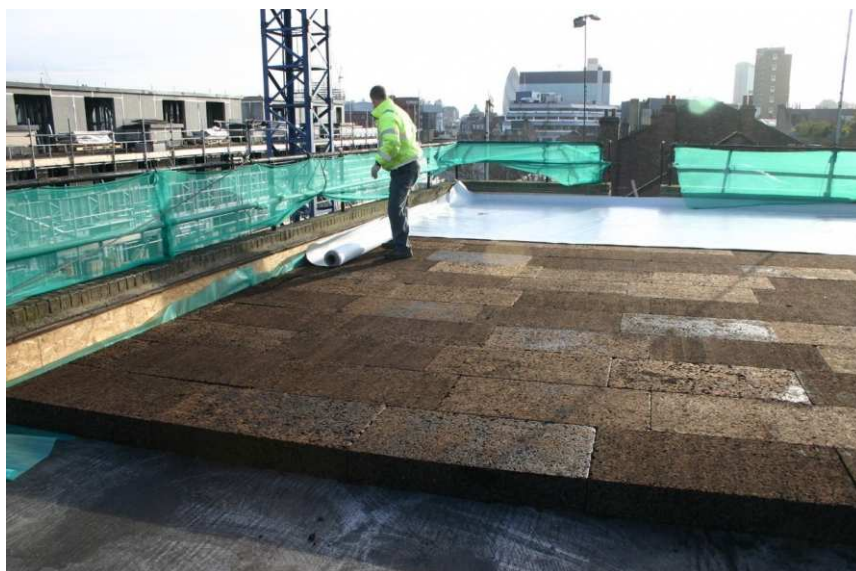
Figura 25 – Circulação de pessoas sobre o isolamento térmico e acústico de cortiça, em fase de obra para aplicação da impermeabilização [41]
