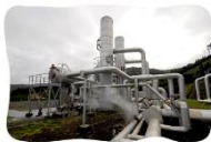
Central geotérmica da Ribeira Grande (São Miguel)
