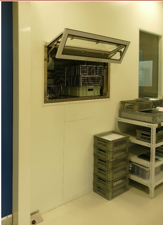
Figura 20 - Janela de movimentação de peças entre a sala de apoio (isolada) e a sala de controlo.
