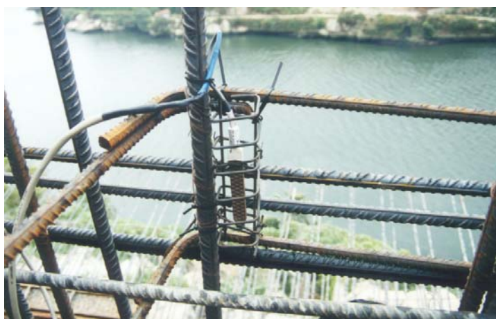
Figura 10.48 — Extensómetro instalado no montante M6.
