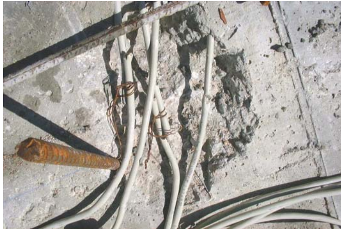
Figura 2.7 — Cabos danificados em obra.
