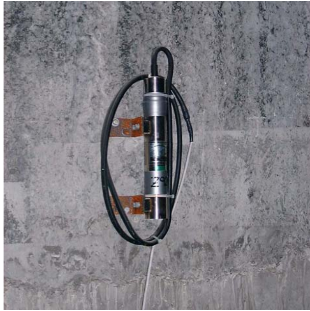
Figura 8.5 — Inclinómetro eléctrico aplicado em obra.
