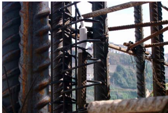
b) Pormenor de um extensómetro instalado
