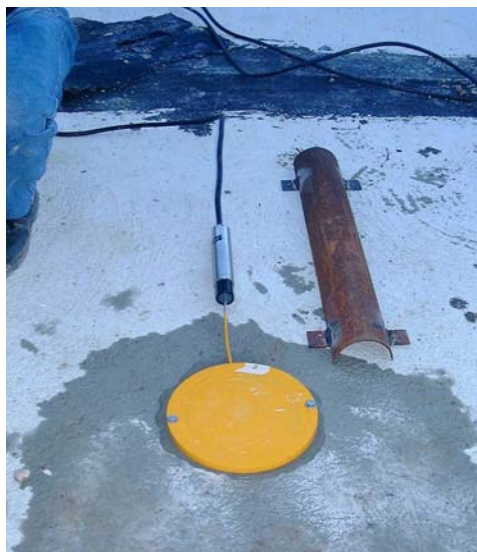
Figura 10.29 — Protecção mecânica do sensor de pressão.
