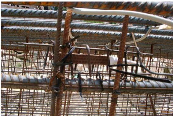
a) Pormenor de um extensómetro instalado
