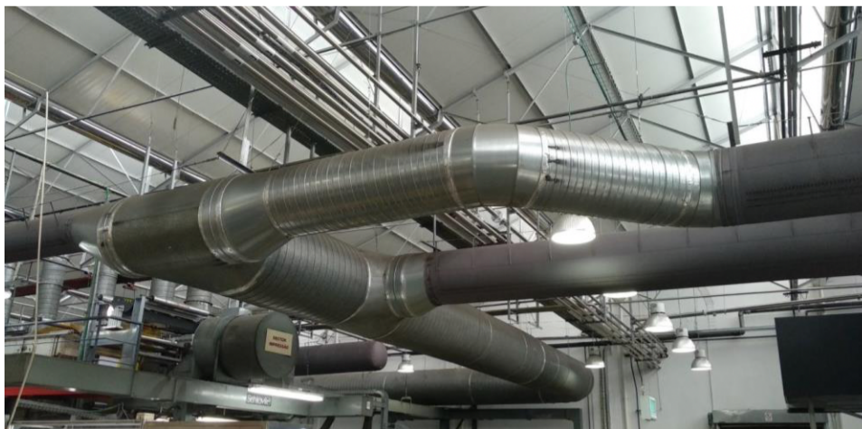
Figura 4-15: Conduitas e mangas têxteis das UTAs da instalação
