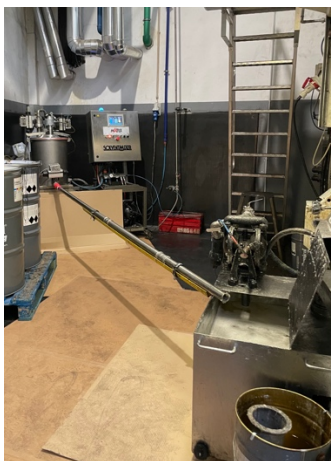
Figura 4-3: Zona de cola nas máquinas de complexagem com solvente
