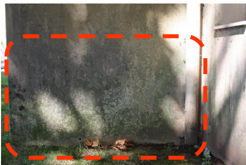
Figura 4.54 – Bloco C2, fachada exterior com manchas, fungos e musgos
