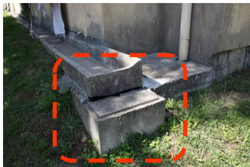
Figura 4.59 – Bloco C3, caleira de águas pluviais exteriores
