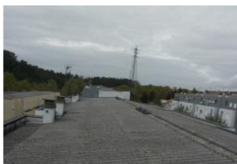
Figura 4.23 – Bloco D2, chapa em fibrocimento da cobertura inclinada
