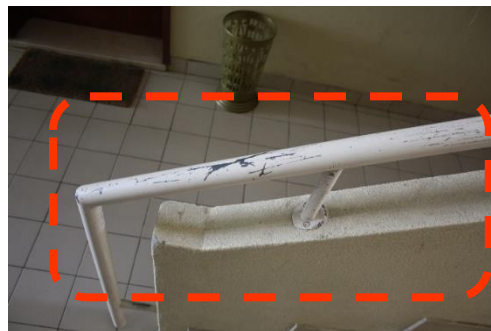
Figura 4.81 – Bloco C2, corrimão da caixa de escadas de escadas
