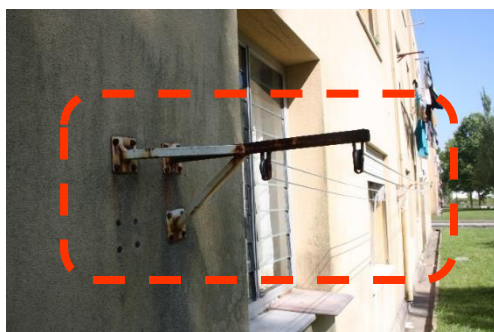
Figura 4.60 – Bloco C2, deterioração das estruturas metálicas
