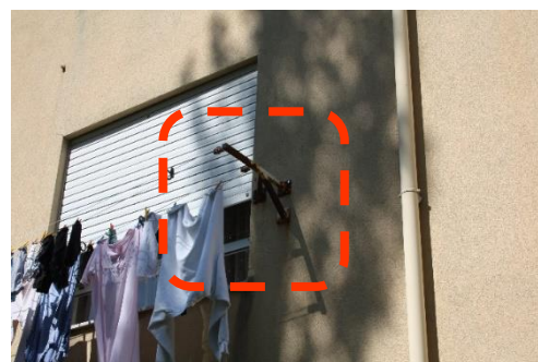
Figura 4.61 – Boco C3, deterioração das estruturas metálicas
