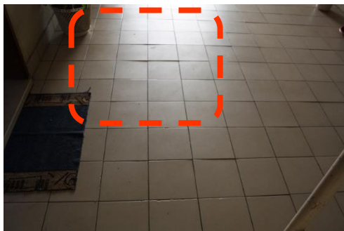
Edifício 4.79 – Bloco C2, zona comum, pavimento interior
