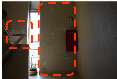
Figura 4.78 – Bloco C2, zona comum, destacamento da pintura e reboco nas paredes interiores
