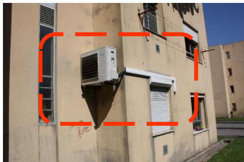
Figura 4.43 – Bloco C2, equipamento elétrico e calhas
