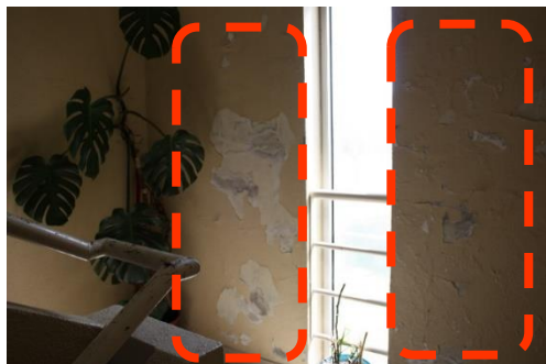
Figura 4.77 – Bloco C2, zona comum, destacamento da pintura e reboco nas paredes interiores
