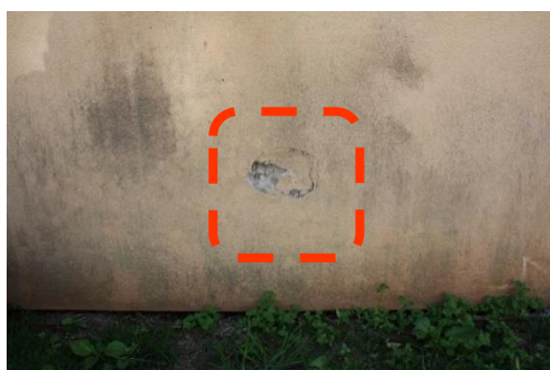
Figura 4.56 – Bloco c2, deterioração da fachada
