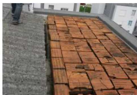
Figura 4.24 – Bloco D2, chapa em fibrocimento da cobertura inclinada
