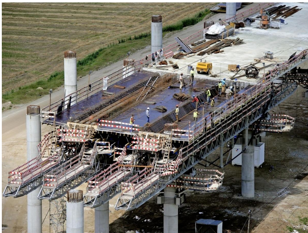
Figura 73 – Construção do viaduto sobre o Rio Sousa, em Lousada, na Auto-Estrada A11 (17-05-2005)
