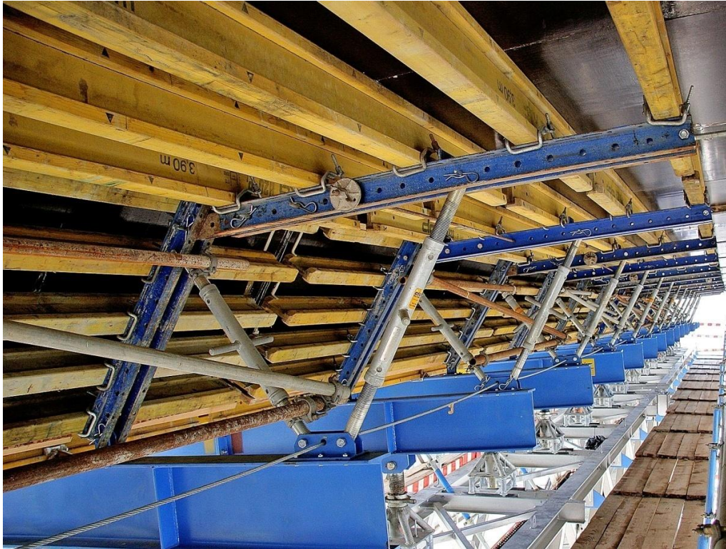
Figura 76 – Pormenor da cofragem do cimbra utilizado no viaduto sobre o rio Sousa (12-05-2005)
