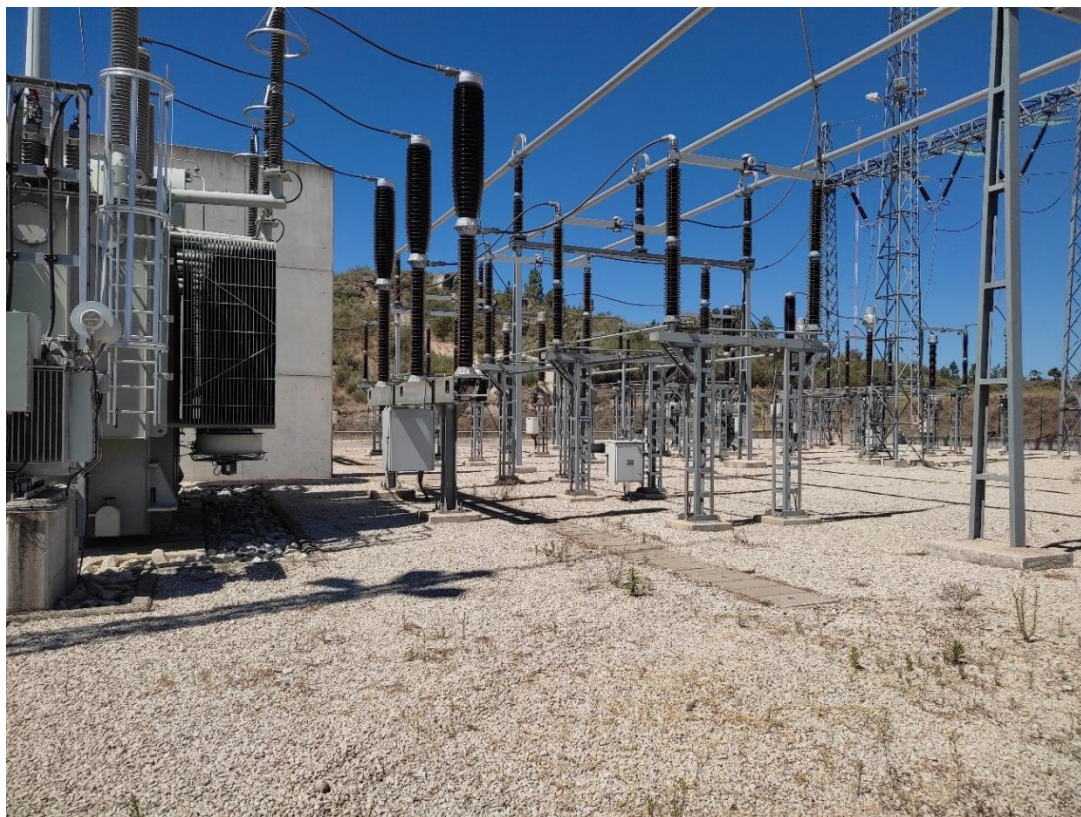
Figura 5 - Subestação de São Martinho
