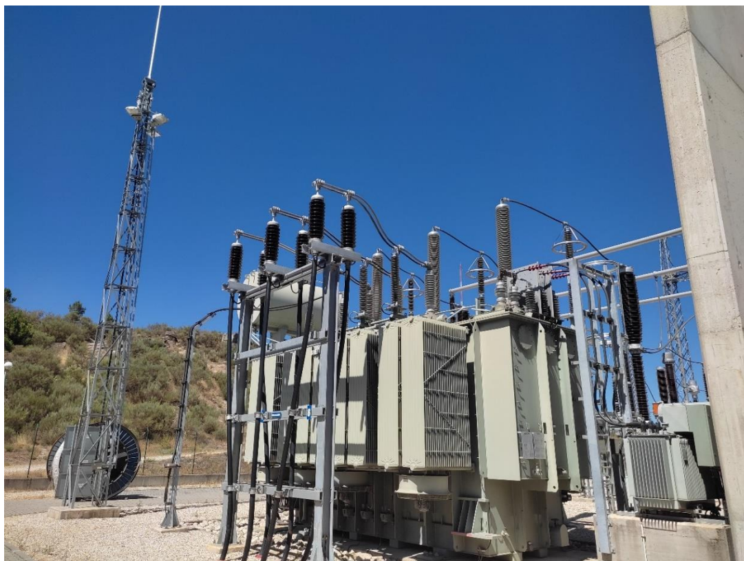
Figura 9 - Segundo transformador da subestação de São Martinho
