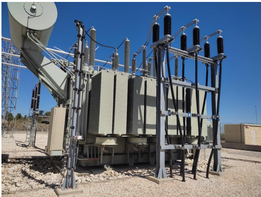
Figura 8 - Primeiro transformador da subestação de São Martinho
