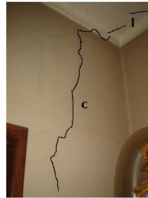
Figura 82 – Fissura na parede "c"
