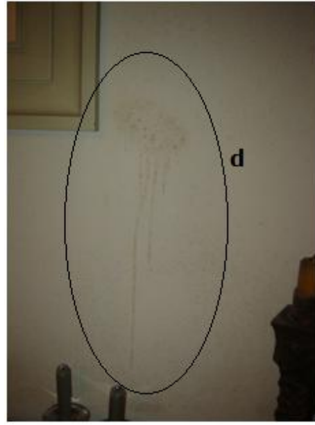
Figura 66 – Escorrimento parede “d”
