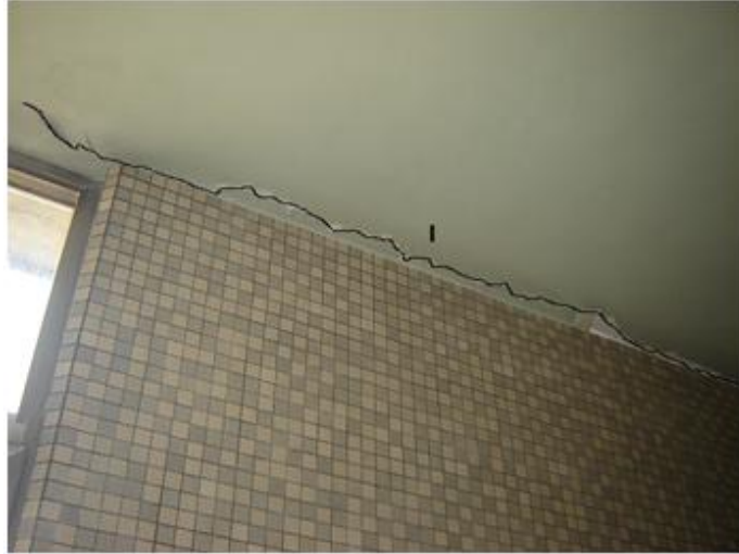
Figura 105 – Fissuração e descascar de pintura no tecto
