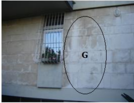
Figura 126 – Mancha na parede “G”
