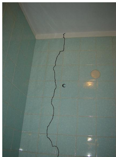
Figura 72 - Fissura vertical no Quarto de banho “c”
