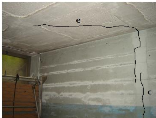
Figura 109 – Fissura localizada no tecto e na parede
