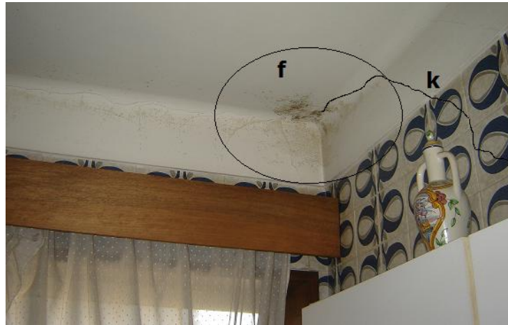
Figura 88 – Humidades no canto do lado esquerdo e fissura a 45° “f; k”
