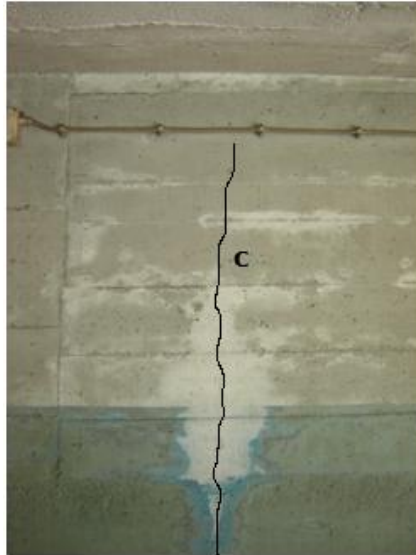
Figura 108 – Fissura acompanhada de infiltração na parede
