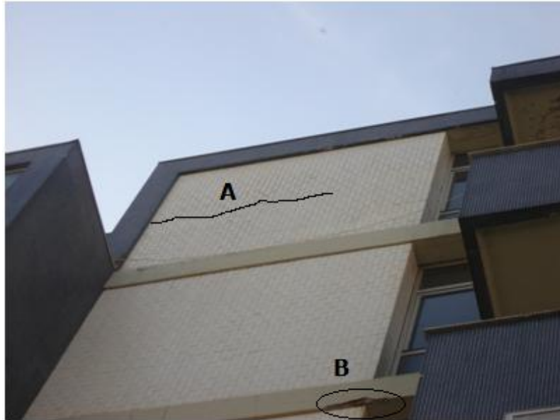
Figura 123 – Fissuras/Fendas na parede “A” e destacamento do betão”B”
