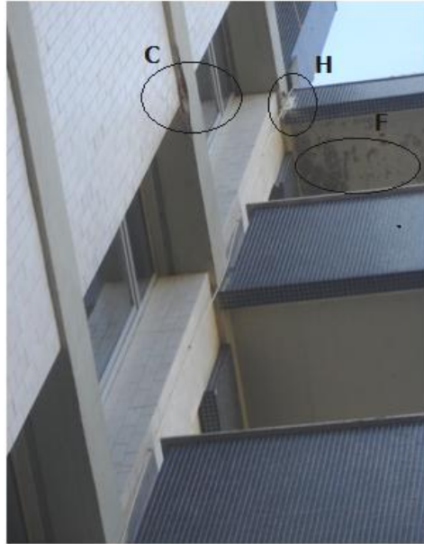
Figura 128 – Escorridos de sujidades “H”, descascar de tinta “F” e destacamento recobrimento “C”
