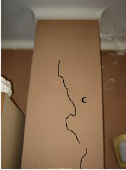
Figura 94 – Fissura no pilar norte “c”
