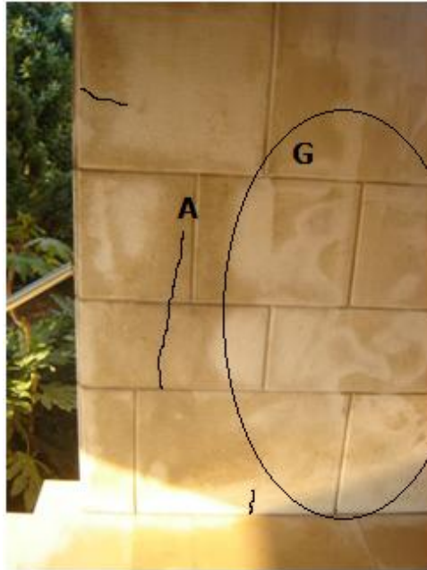
Figura 120 – Fissuras “A” e manchas na pedra “G”
