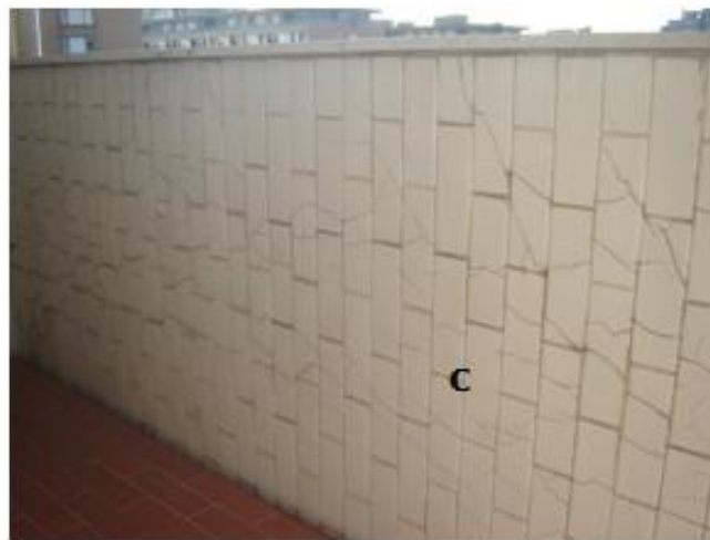
Figura 102 – Fissuras na guarda da varanda “c”
