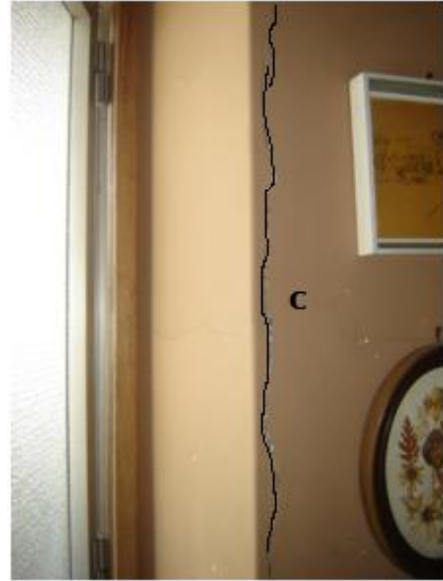
Figura 95 – Fissura no pilar sul “c”
