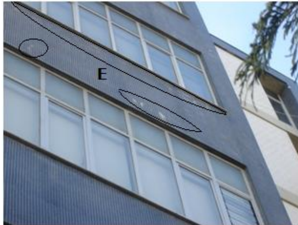
Figura 121 - Efluentes no avançado "E"
