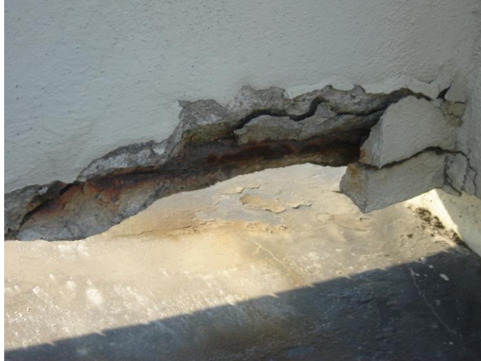
Figura 136 – Delaminação do betão e armadura à vista na zona inferior da guarda
