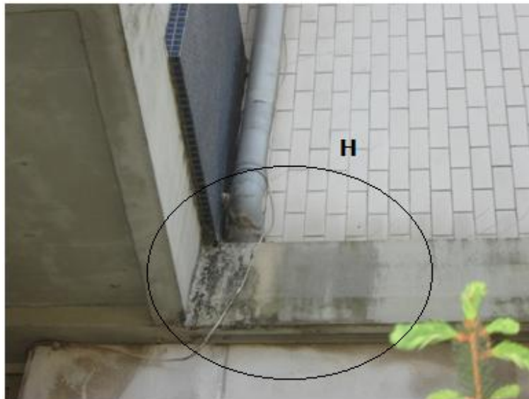
Figura 133 – Escorridos e humidade “H”
