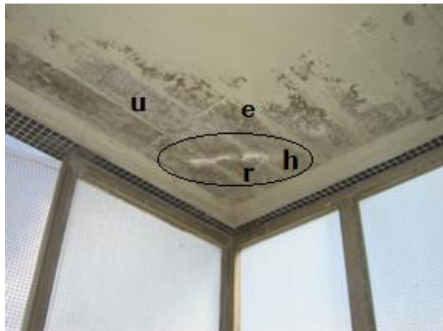
Figura 96 – Infiltração no tecto “r; h, u”
