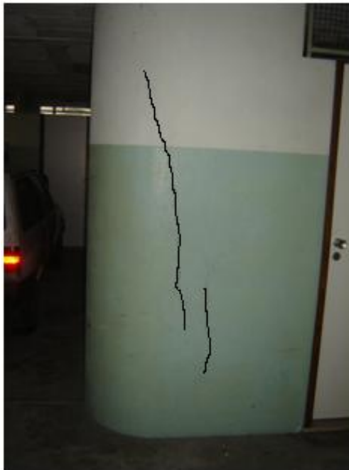
Figura 111 – Fissura na parede da arrecadação
