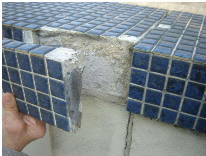
Figura 139 – Destacamento de betão juntamente com pastilha adjacente a uma junta de dilatação
