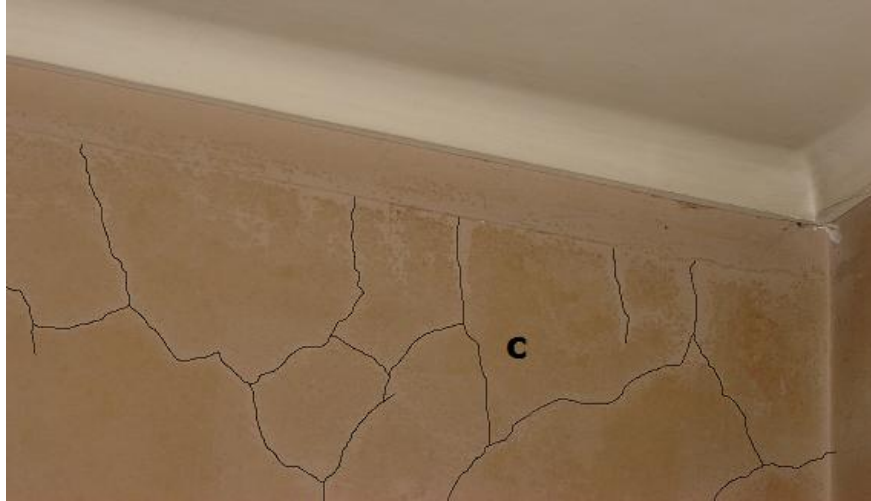
Figura 77 – Fissuras na parede “c”
