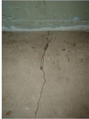
Figura 110 – Fissura localizada no pavimento
