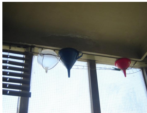
Figura 91 – Infiltração no tecto “h”
