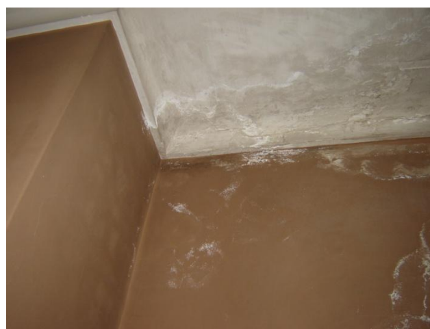
Figura 93 - Humidade na parede e tecto do lado norte “q; r; h”
