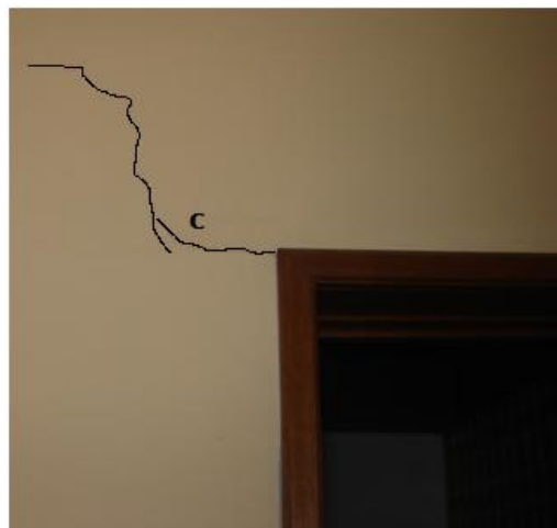
Figura 99 – Fissura no canto da porta “c”
