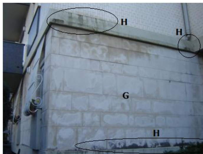
Figura 129 – Manchas na parede “G” e sujidades “H”
