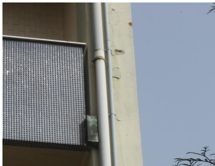
Figura 119 – Delaminação do betão e pormenor da recolha de águas
