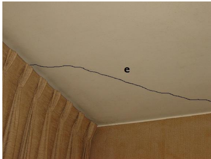
Figura 75 – Fissura orientada a 45° “e”
