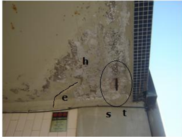
Figura 101 – Armadura à vista “t; u; h; s; f; e”
