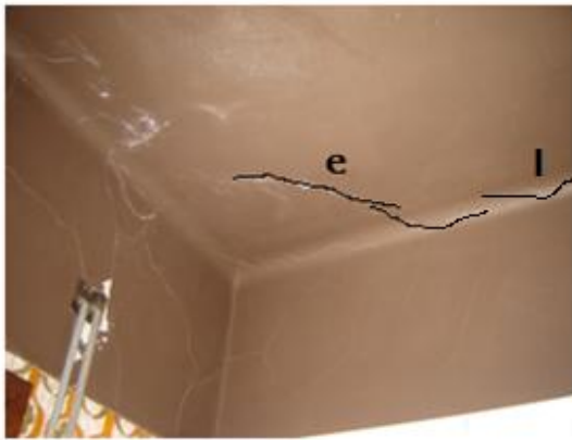
Figura 97 – Fissura localizada “e”
