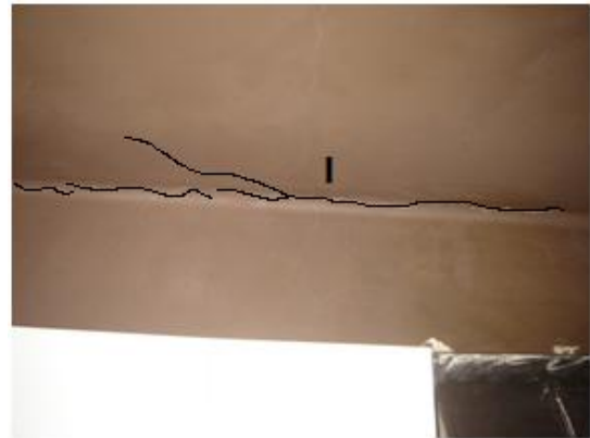
Figura 98 – Fissura no bordo da parede e tecto “l”
