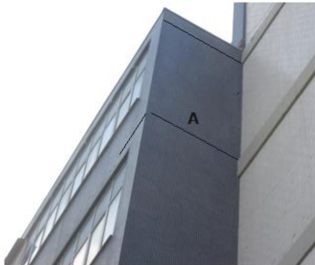
Figura 127 – Fissuras/Fendas horizontais no avançado “A”
