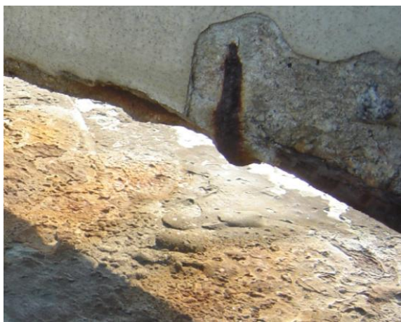
Figura 3 – Corrosão em betão armado
