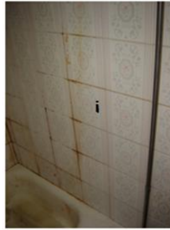
Figura 86 – Humidade nas juntas dos azulejos “i”
