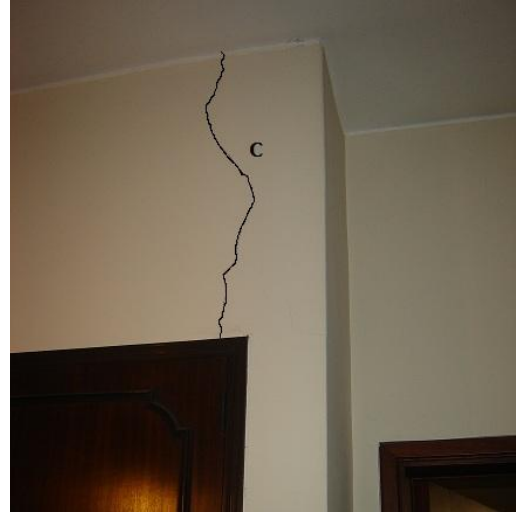
Figura 68 – Fissura no hall de entrada “c”
