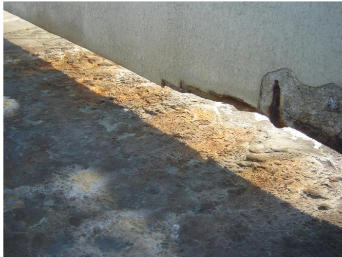
Figura 137 – Armadura e estribos à vista na guarda
