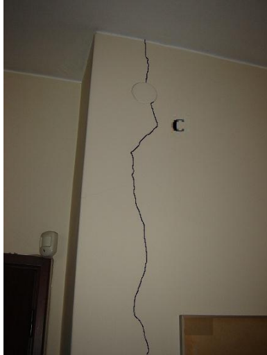
Figura 67 – Fissura na sala comum “c”
