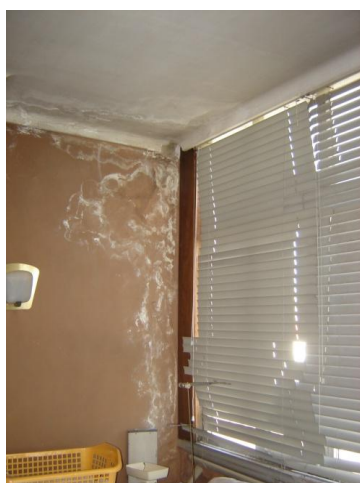
Figura 92 – Anomalias na parede do lado norte “a; q; s; r; h”
