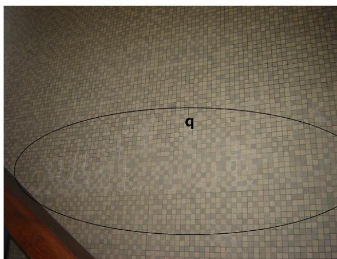
Figura 104 – Vestígios de eflurescências
