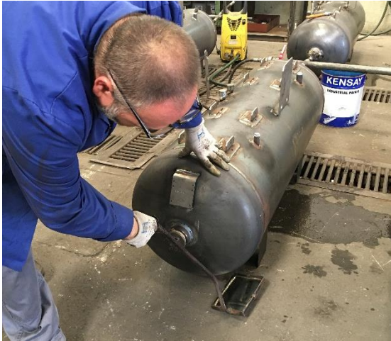
Figura 29 – Verificação do pré-reservatório
