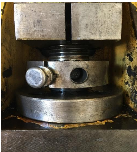
Figura 54 – Falta de proteção da biela do Balancé
