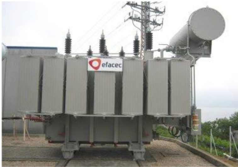
Figura 4 - Transformador trifásico de imersão a óleo de 20 MVA
