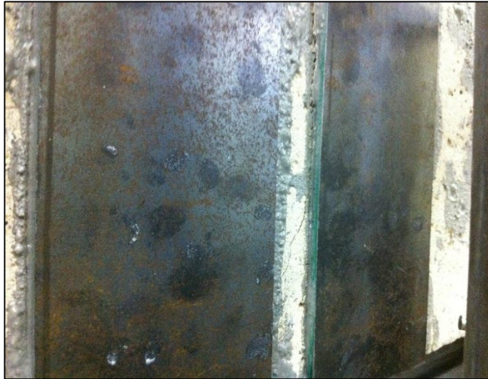
a) Fissuras Horizontais
