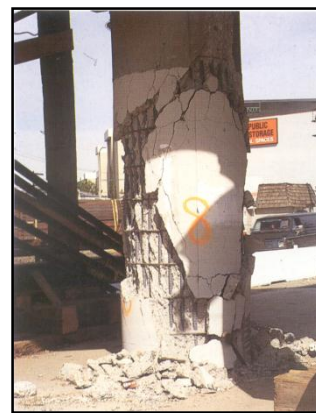
b) Pilar sem reforço no sismo de “Northridge”
