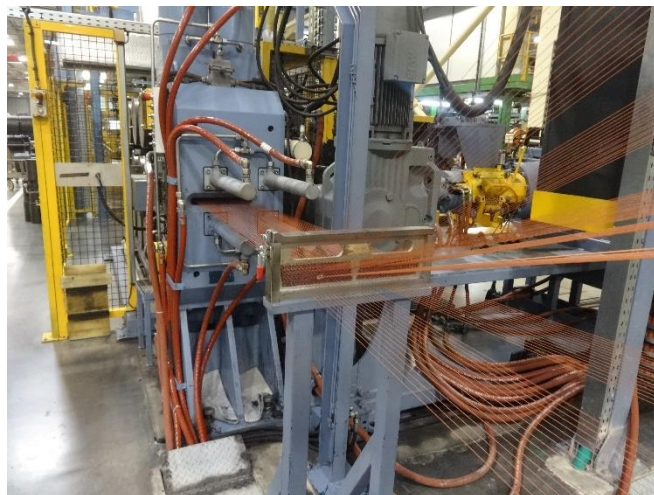
Figura 57 - Placa perfurada entre o creel e o cabeçote da máquina.
