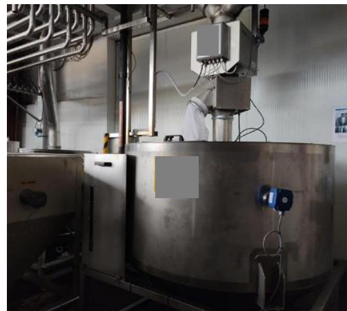
Figura 30 - Silo de acumulação de moído
