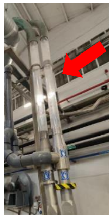
Figura 20 - Tubagens de transferência
