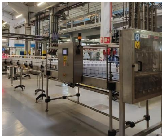
Figura 27 - Mesa de acumulação de garrafas da L312
