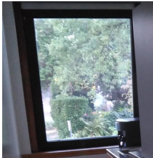
Figura 55 – Vão envidraçado – VE1_380
