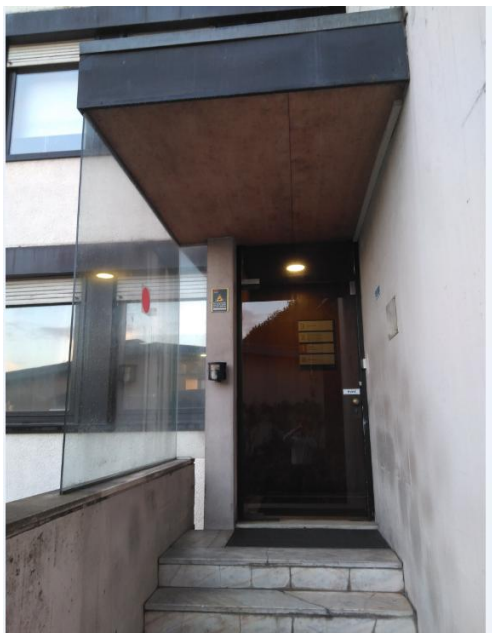
Figura 52 – Vão envidraçado – VE2_420
