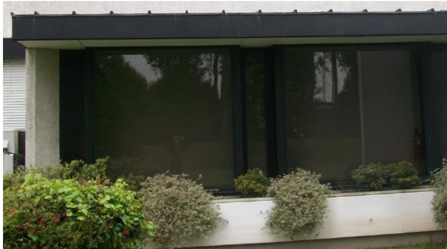
Figura 61 – Vão envidraçado VE2_21E e VE2_23E.
