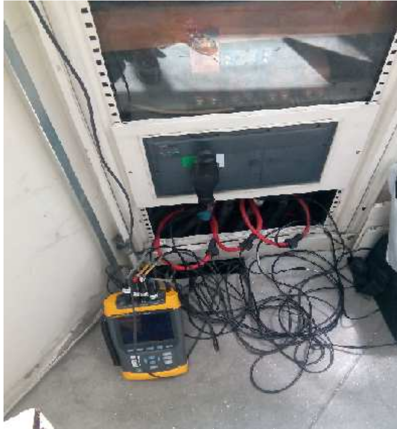
Figura 42: Analisador de energia em medição no quadro elétrico da P2
