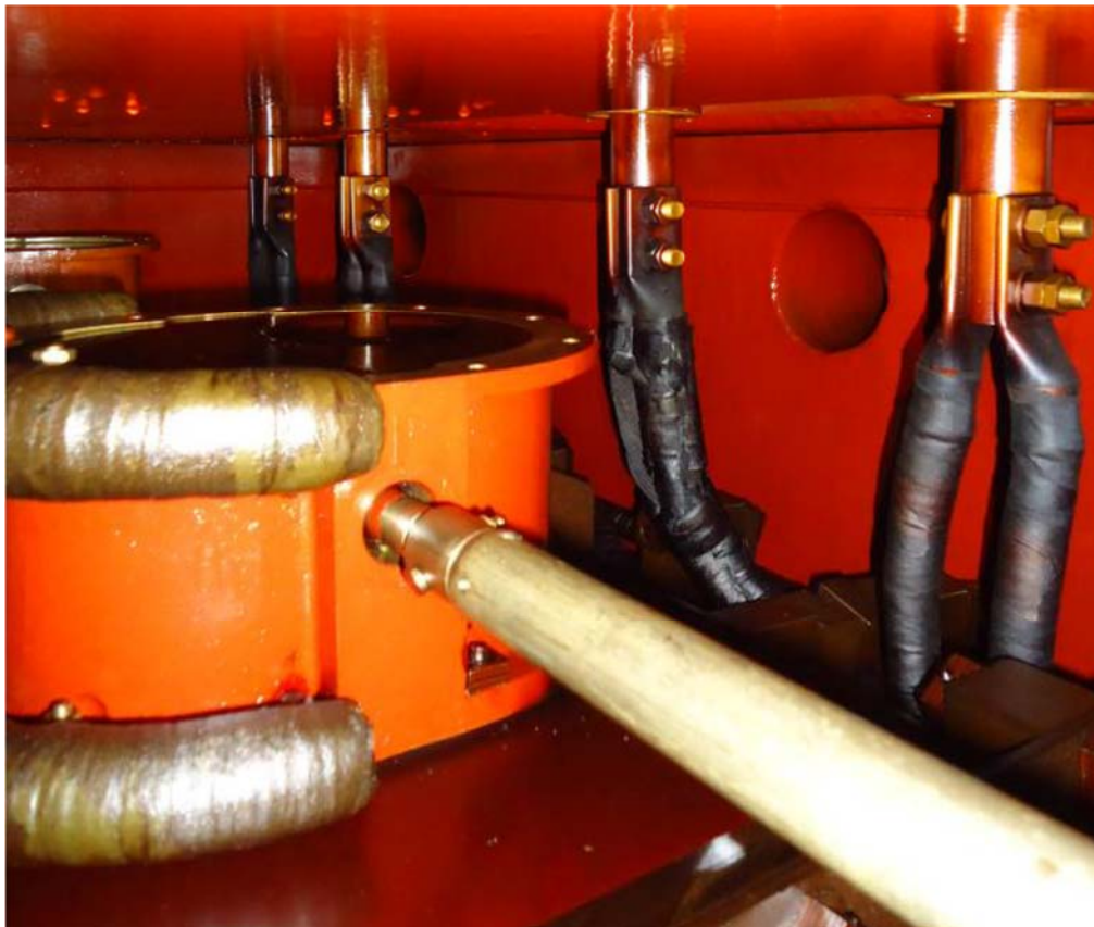
Figura 5.5 – Vista geral das ligações entre as travessias e o enrolamento secundário completamente carbonizadas.
