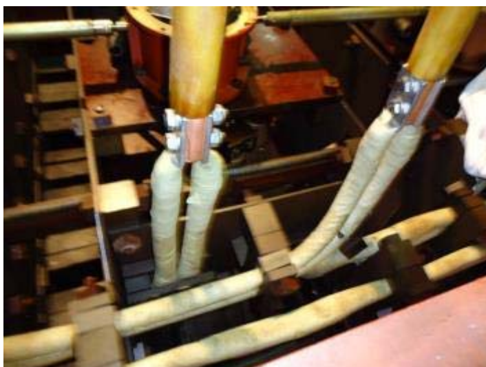
Pontas com terminais cravados, isolados e ligados aos pernos das travessias
