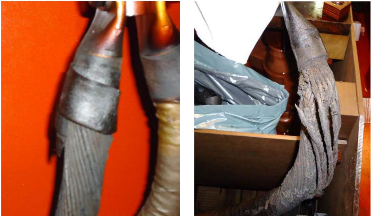
Figura 5.6 – Vista em pormenor das ligações entre as travessias e o enrolamento secundário completamente carbonizadas.
