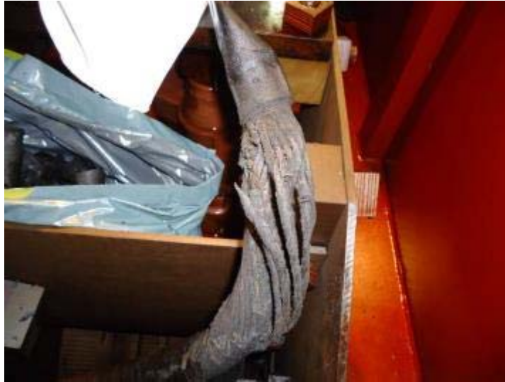
Um dos cabos já apresentava fios de cobre fundidos.
