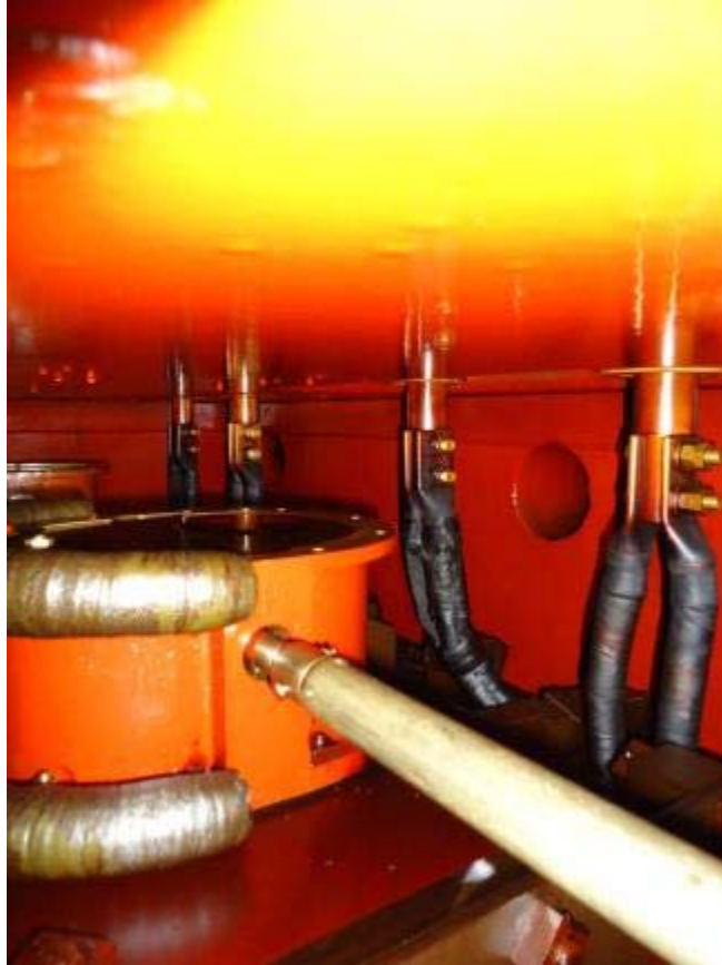
Vista geral do interior das ligações dos cabos da BT às travessias.
