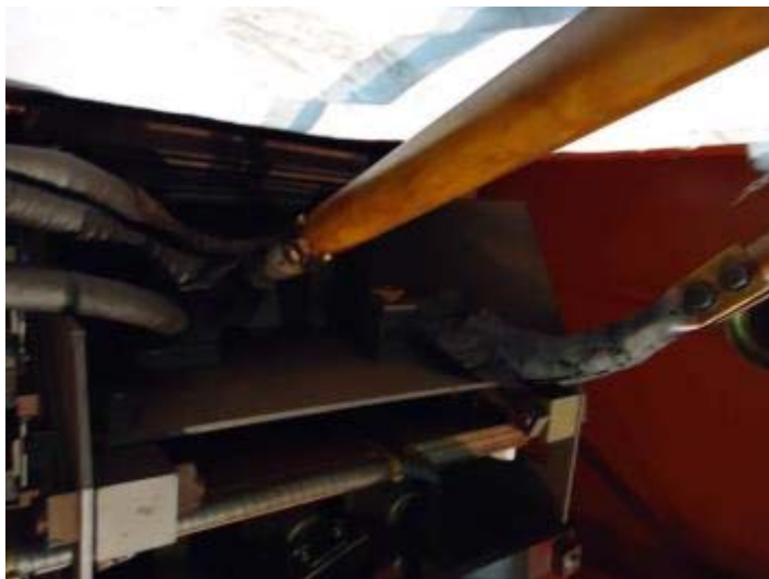
Situação verificada após remoção da tampa
