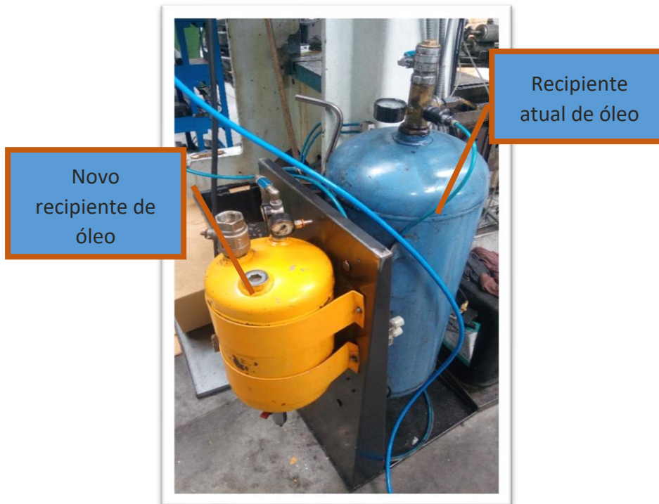
Figura 74 - Sistema de dois recipientes de óleo no posto M02/30.
