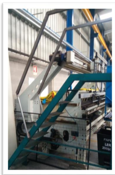
Figura 75 - Escadas PressRoss antes de modificações.
