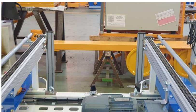
Figura 157 – Instalação do sensor no RGV
