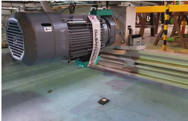
Figura 123 – Instalação do leitor RFID no RGV
