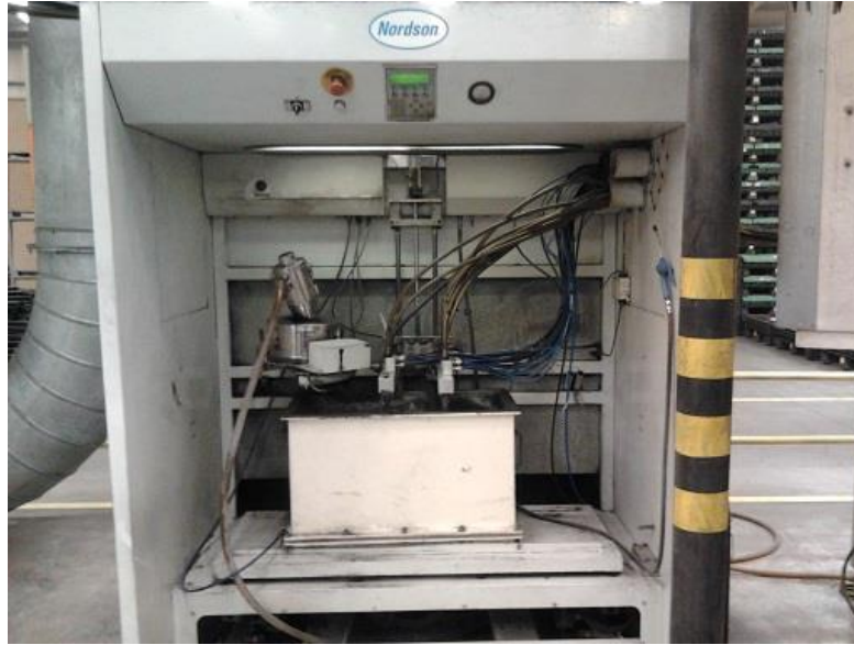
Figura 57 – Centro de cor de abastecimento de pó
