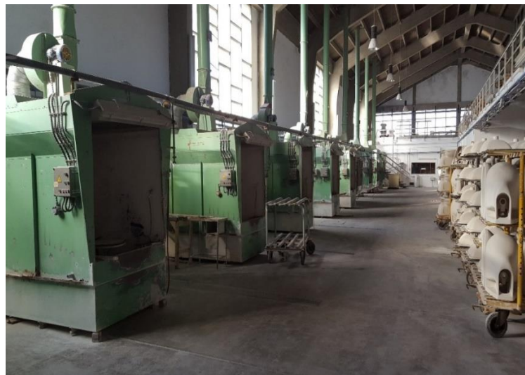
Figura 3.6 – Cabine de vidração.
