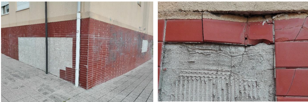
Figura 5.20 - Queda e destacamento do revestimento cerâmico
