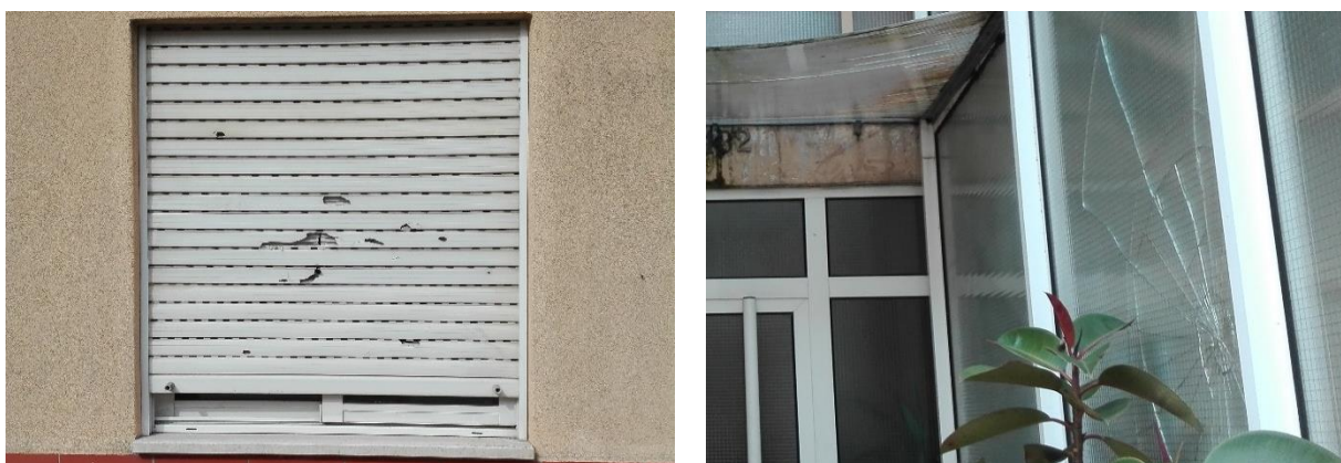
Figura 5.23 - Vandalismo de caixilharias e vãos envidraçados
