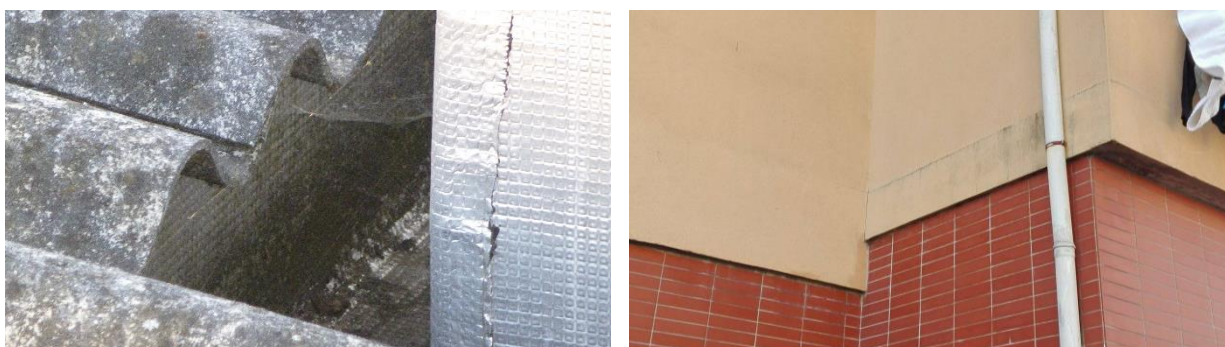
Figura 5.10 - Caleiras interiores e tubos de queda
