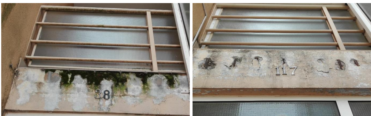
Figura 5.22 - Escorrências, formação de fungos e exposição das armaduras
