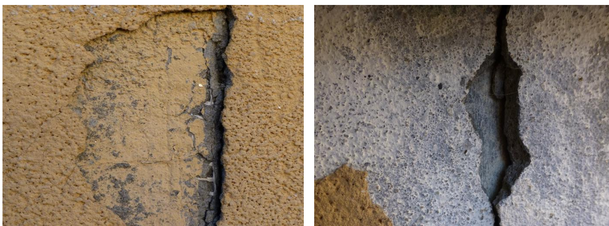
Figura 5.18 - Fissuração do revestimento
