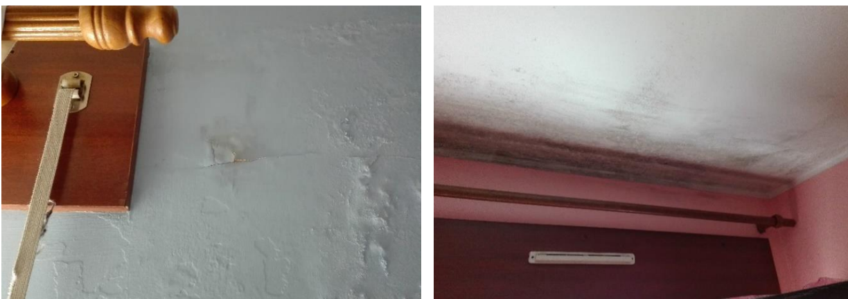
Figura 5.26 - Infiltrações e formação de bolores nas paredes interiores
