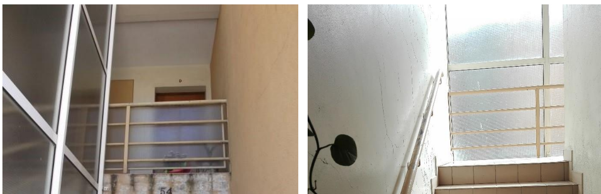
Figura 5.13 - Guardas de proteção
