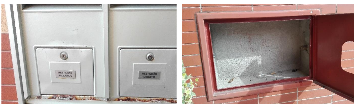
Figura 5.25 - Corrosão das caixas de correio e vandalismo de outros elementos
