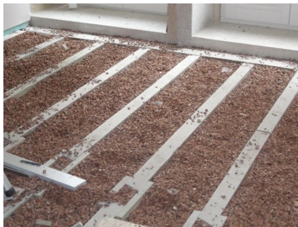
Figura 5.12 – Aplicação do granulado de cortiça entre as vigas secundárias (vista superior do pavimento)
