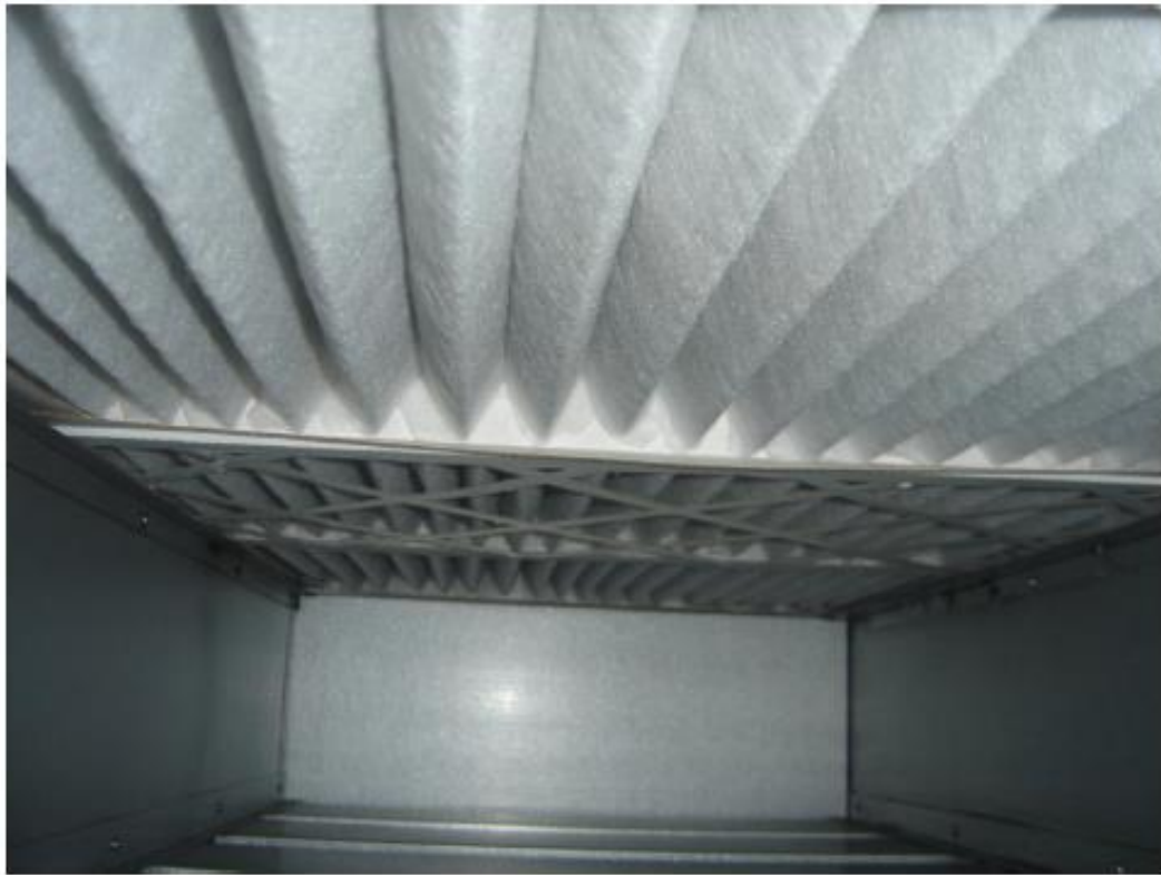
Figura 22 - Estado de pré filtros após da intervenção de Manutenção Preventiva (Fonte: Autor)
