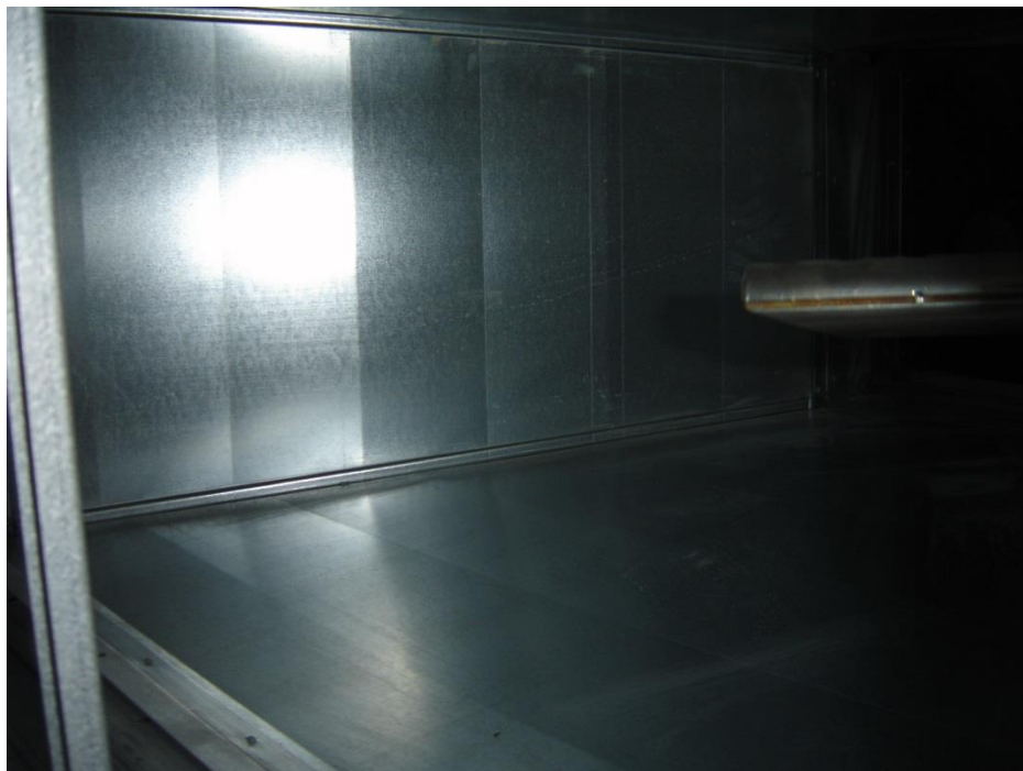
Figura 24 – Estado de higienização do interior da UTA, após a intervenção de MP (Fonte: Autor)
