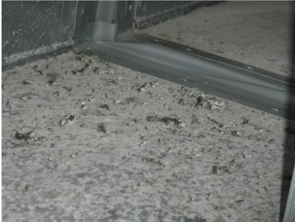
Figura 23 – Estado de higienização do interior da UTA, antes da intervenção de MP (Fonte: Autor)
