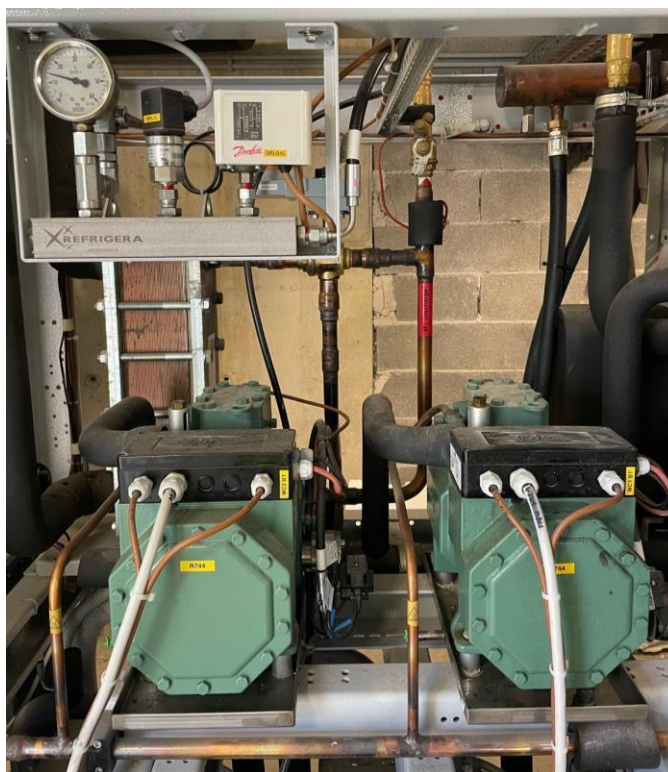
Figura 35-Compressores semi-herméticos de Baixa Temperatura da Bitzer, utilizados na instalação em estudo
