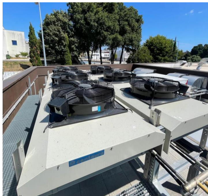
Figura 39- Gas cooler da instalação
