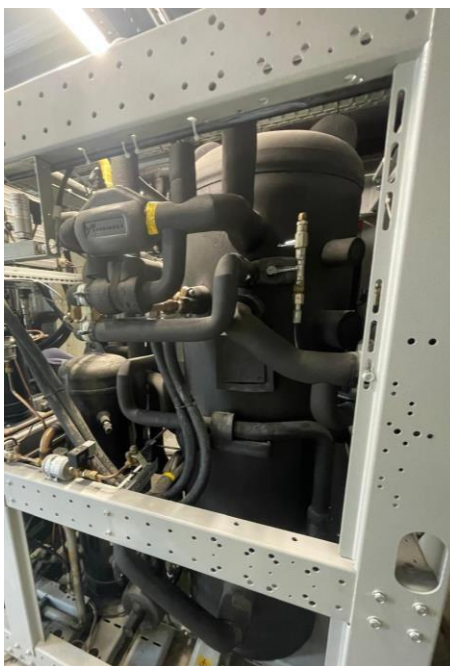
Figura 40- Depósito intermédio usado na instalação
