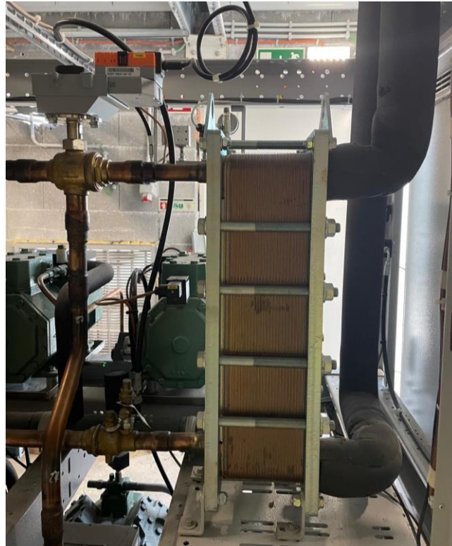
Figura 41- Permutador da instalação
