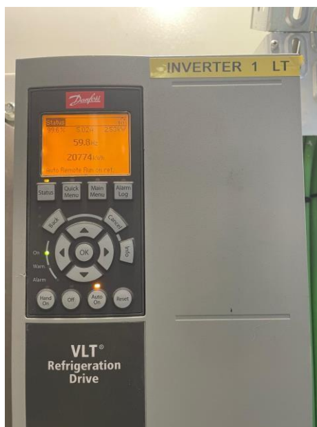
Figura 36-Inversor de frequência de um dos compressores de Baixa Temperatura da Danfoss
