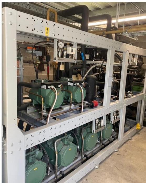
Figura 34- Central frigorífica instalada na loja
