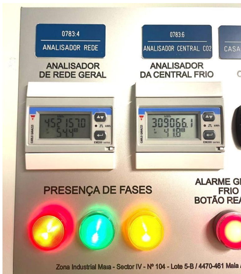
Figura 44-Painel com a energia da rede geral e da central frigorífica
