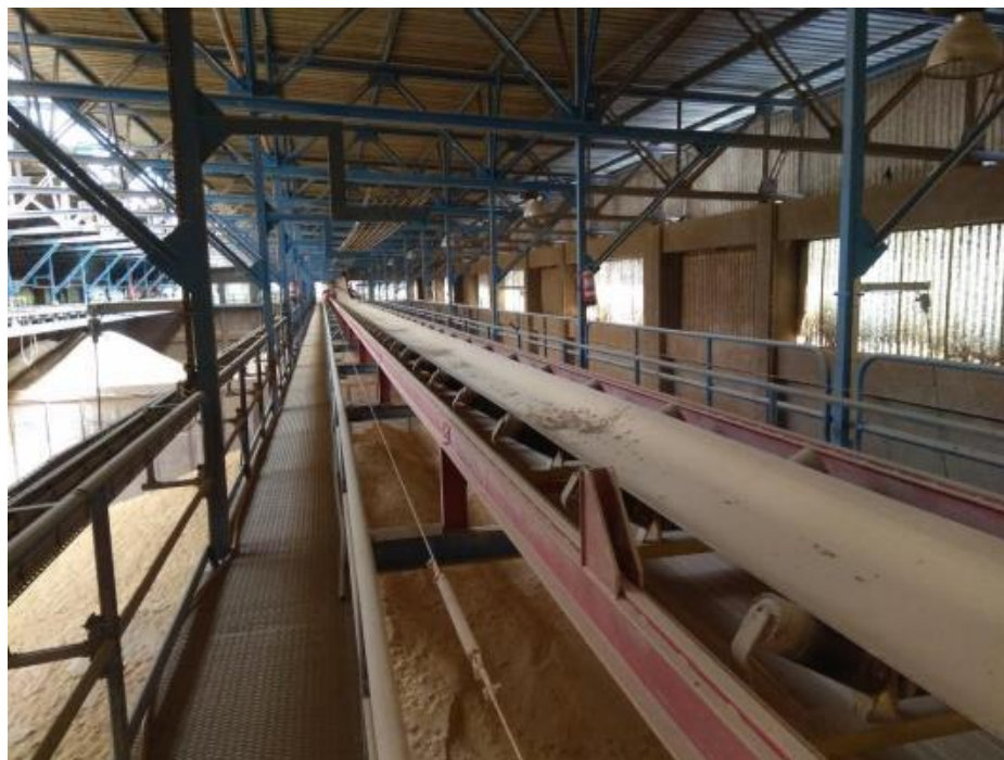
Figura 26 - Transportador de banda, localizado no Armazém Horizontal
