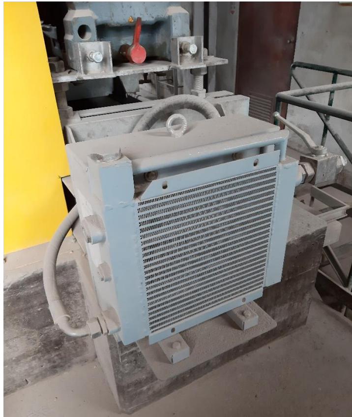
Figura 48 - Permutador óleo-ar do Redutor da Nora E3
