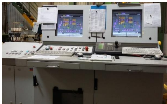
Figura 3.8 – Quadro de comando da máquina de impregnar tela (HMI).
