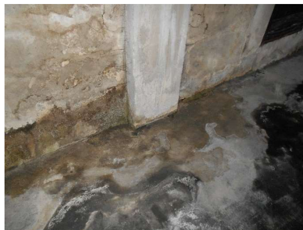
b) Humidade generalizada nas paredes.
