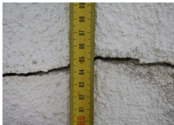
b) Fenda horizontal na ligação muro/viga.
