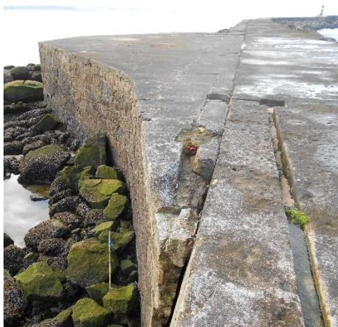
c) Ligação do patamar em alvenaria com o corpo do molhe com sinais de fendilhação e destacamento.
