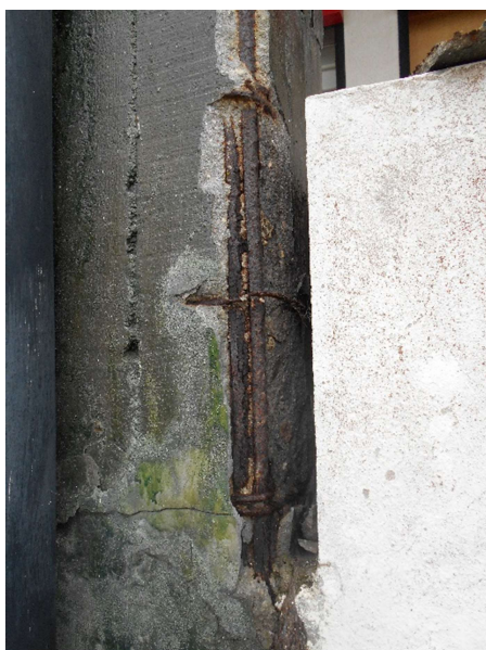
a) Destacamento com exposição de armaduras no pilar P2.
