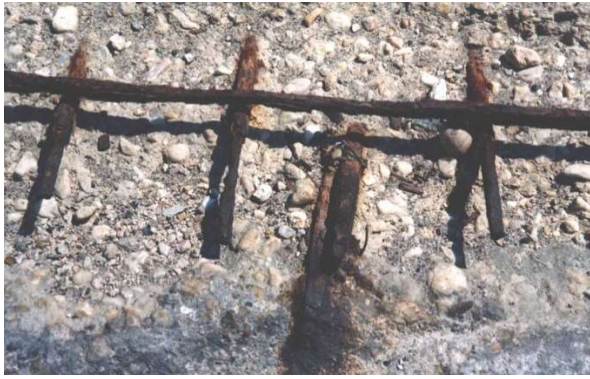
a) Corrosão por picadas (www.bushman.cc).
