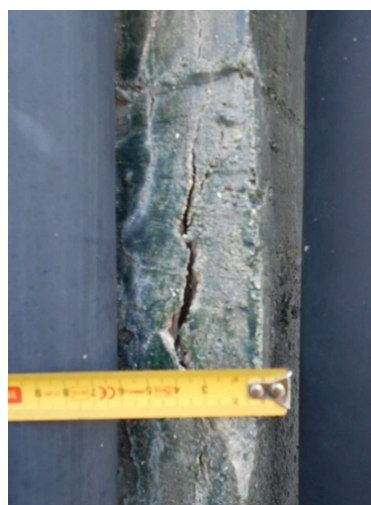
b) Delaminação presente no pilar P2.
