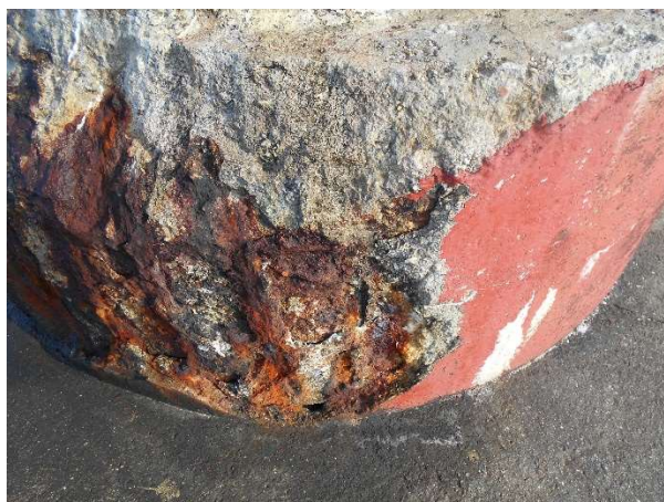
b) Pormenor da base, voltada a sul, com sinais de corrosão por picadas, perda de secção da armadura e destacamento.
