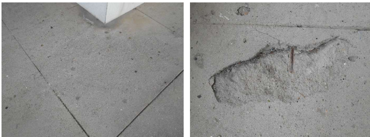
a) Abrasão generalizada no pavimento.
