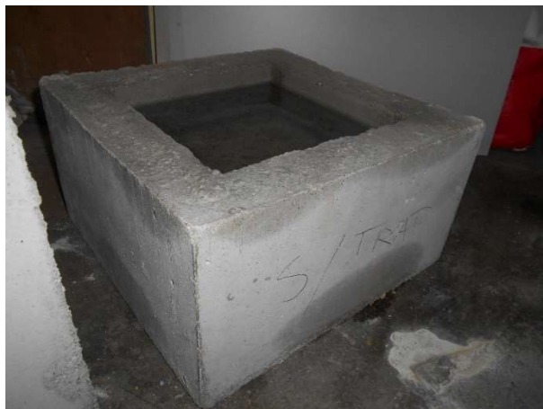
Figura 4.31 – Superfície sem revestimento com sinais de humidade.
