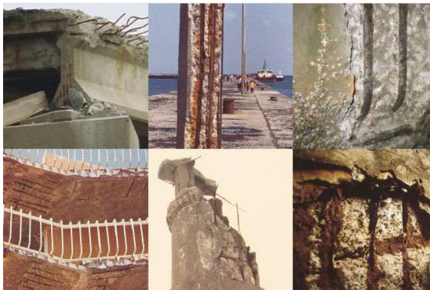
Figura 2.4 – Corrosão das armaduras em betão armado (www.metalica.com.br).
