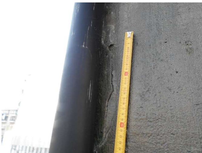
a) Delaminação presente no pilar P1.
