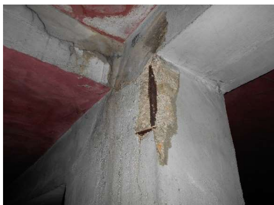
a) Pilar P11 antes da intervenção.
