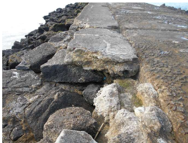
d) Desagregação dos elementos constituintes do corpo do molhe.
