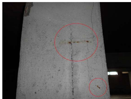
b) Machas de ferrugem presentes no pilar P10.
