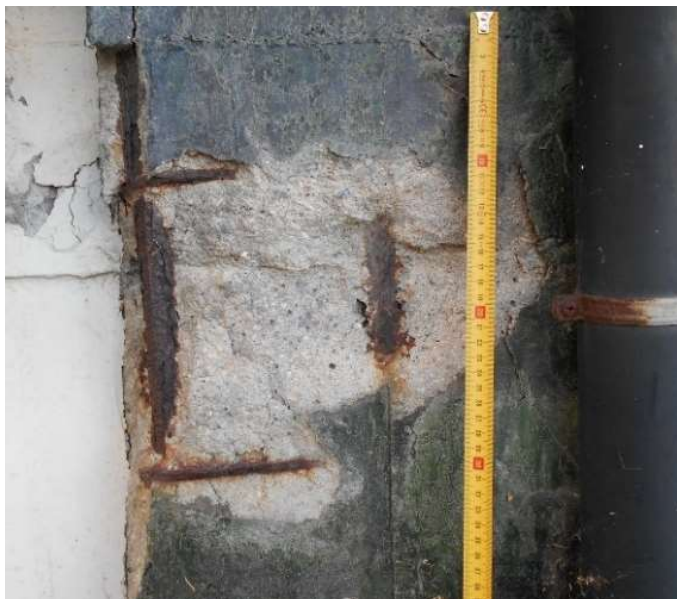
b) Destacamento com exposição de armaduras no pilar P4.
