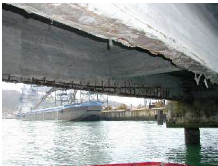
Figura 2.7 – Corrosão e consequente destacamento do betão carbonatado ( www.scielo.mec.pt ).
