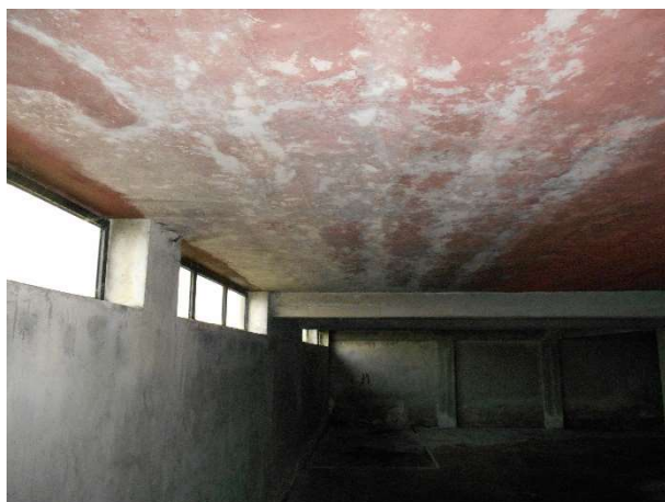
a) Sinais de humidade e infiltração na face inferior da laje do piso exterior.
