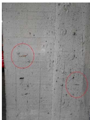
a) Machas de ferrugem presentes no pilar P10.
