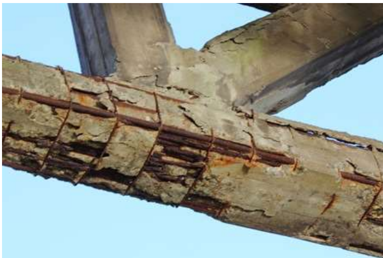
Figura 2.6 – Corrosão da armadura, destacamento e delaminação ( www.clubedoconcreto.com.br ).
