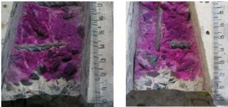
Figura 2.8 – Profundidade de carbonatação (www.cimentoitambe.com.br).
