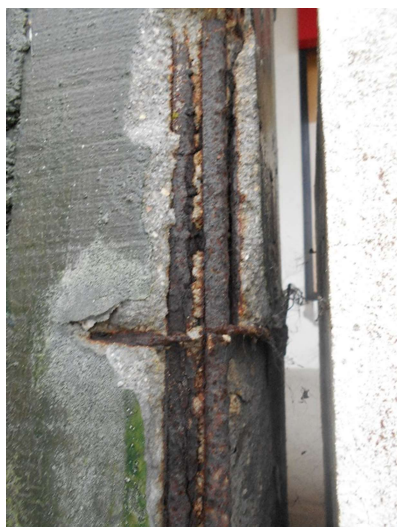
a) Armadura em pilar com corrosão.
