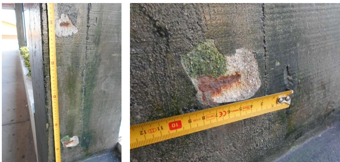
a) Destacamento superficial no pilar P3.
