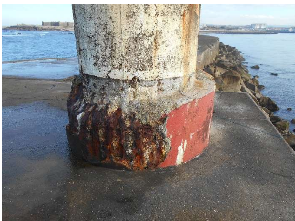
a) Base do farol com sinais de corrosão generalizada e destacamento.
