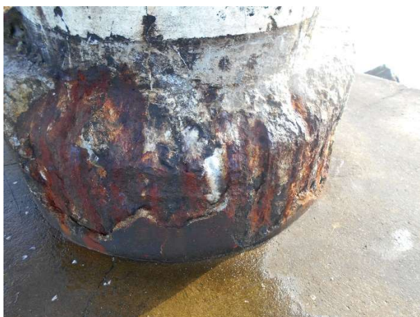
c) Pormenor da base, voltada a oeste, com sinais de corrosão por picadas, perda de secção da armadura, destacamento e cristalização de sais.
