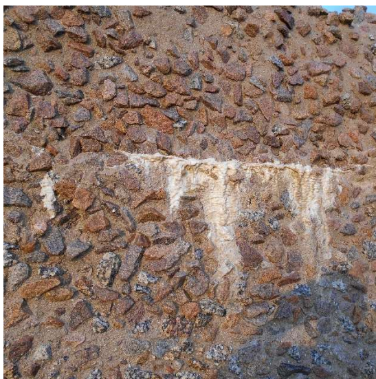
e) Vista lateral do molhe com sinais eflorescências e cristalização de sais.
