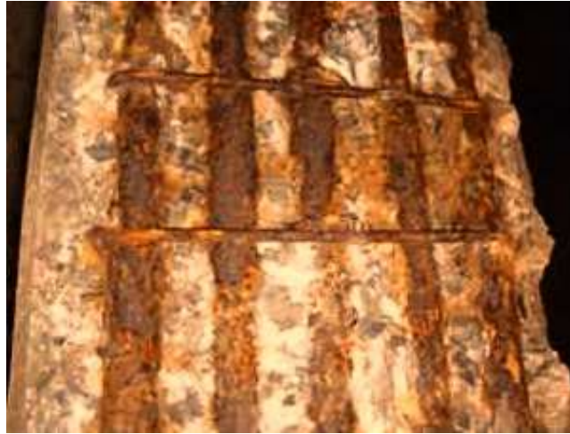
Figura 2.9 – Armadura com corrosão por picadas ( www.clubedoconcreto.com.br ).
