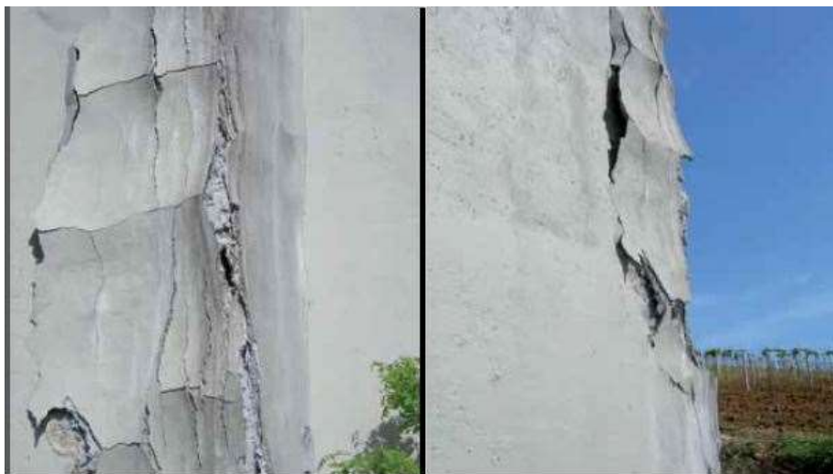
Figura 2.13 – Destacamento e delaminação do betão por ação dos sulfatos (www.mapei.pt).
