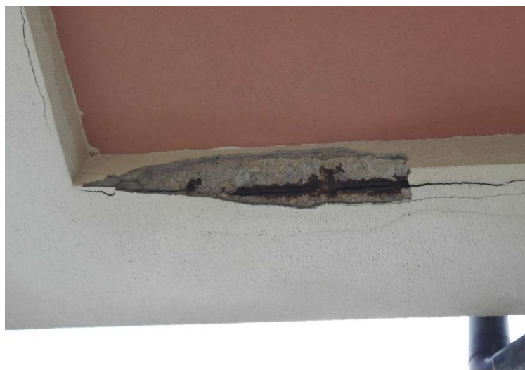
b) Armadura em viga com corrosão.
