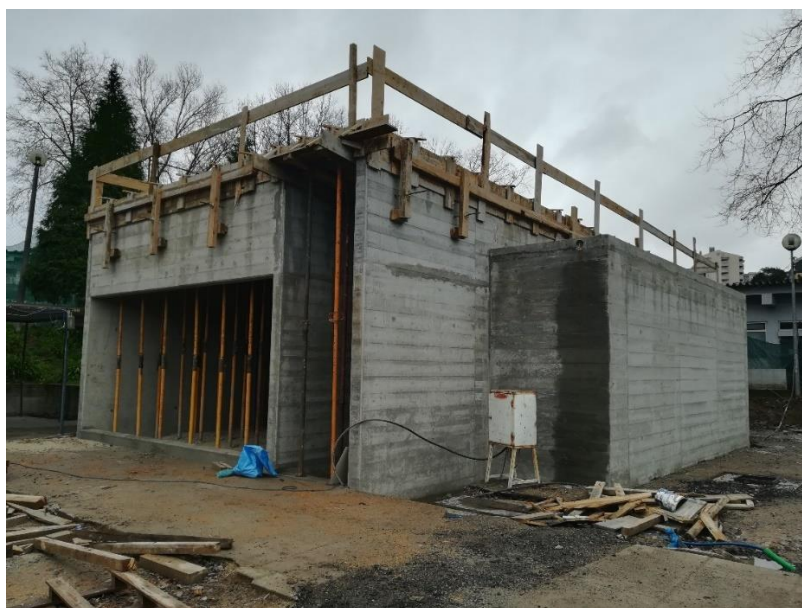
Figura 2.15 – Cofragem e escoramento da laje de cobertura do Alpendre (bloco dos professores)
