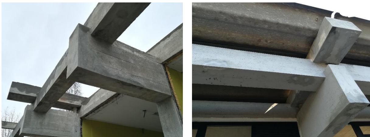
Figura 2.5 - Exemplos do estado (pós intervenção) em elementos estruturais no bloco A4
