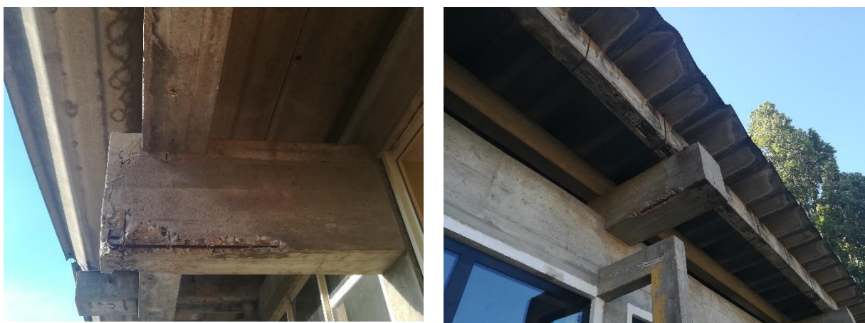
Figura 2.4 - Exemplos do estado (sem intervenção) em elementos estruturais no bloco A4
