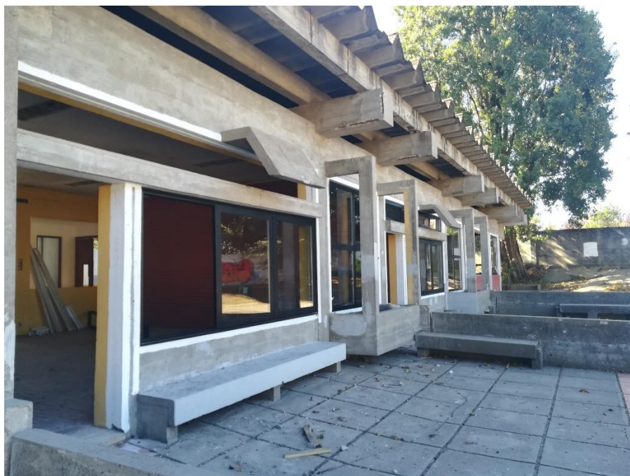
Figura 2.2 – Estado inicial da fachada referente ao bloco A4
