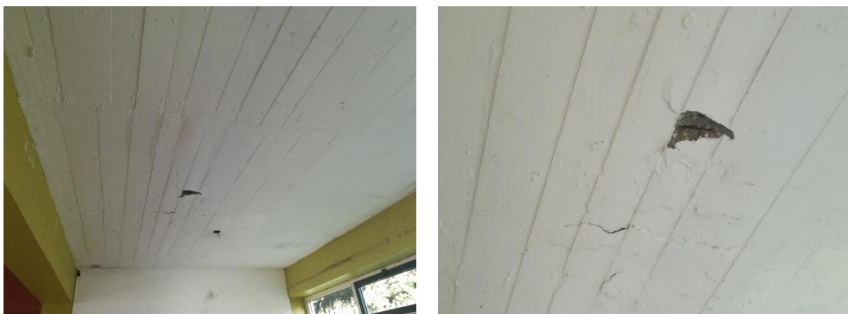
Figura 2.6 – Exemplo do estado inicial (sem intervenção) de uma laje no bloco A4
