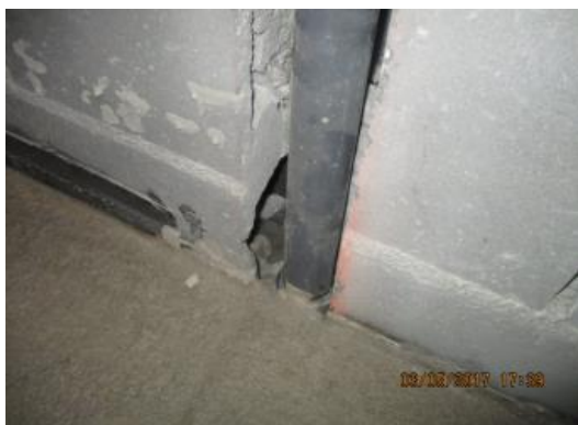
Figura 6.28 – Tela asfáltica mal posicionada nos roços [Data: 2017.05.03]
