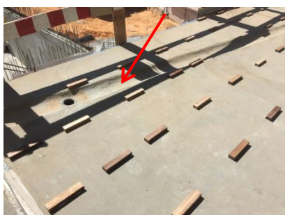
Figura 5.43 – Canelura para escoamento das águas pluviais [Data:04.08.2017]
