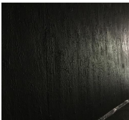
Figura 5.8 – Paredes e Pavimento do Reservatório de Incêndio após aplicação do MasterSeal® 550 [Data: 13.06.2017]
