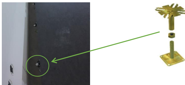
Figura 5.28 – Pavimentos Sobrelevado na sala de Reuniões Modular [Data: 2017.08.08] utilizando uma Estrutura de suporte - Pedestal [Fonte: Ficha técnica Lindner AG]
