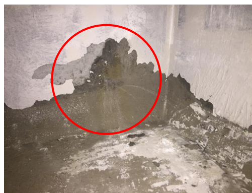
Figura 6.14 – Infiltração do ponto “A” – Reservatório “0-AL-32” [Data: 10.10.2017]
