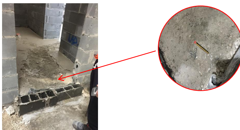
Figura 6.33 – Betão Leve danificado
