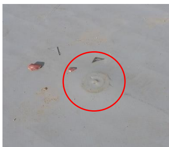
Figura 6.18 – Tela PVC marcada pela bolacha de fixação do PIR [Data: 12.04.2017]
