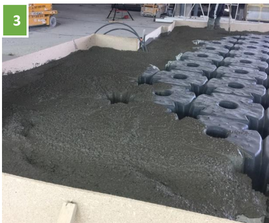
3 – Betonagem para enchimento da área de vazios dos módulos Cupolex (Área 2) – [Data: 16.05.2017]
