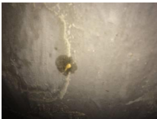
Figura 6.12 – Patologia no Reservatório “0-AL-30” [Data: 10.10.2017]
