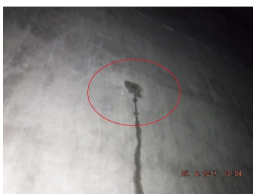
Figura 6.10 – Infiltração reservatório “0-AL-29” [Data: 25.08.2017]
