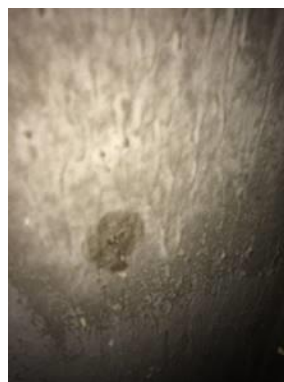
Figura 6.13 – Patologia no Reservatório “0-AL-30” [Data: 10.10.2017]
