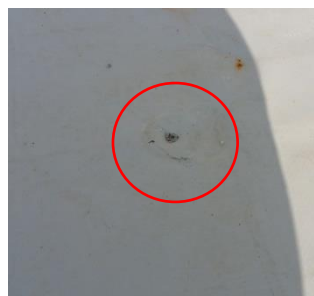
Figura 6.19 – Tela PVC perfurada pelo parafuso de fixação do PIR [Data: 12.04.2017]
