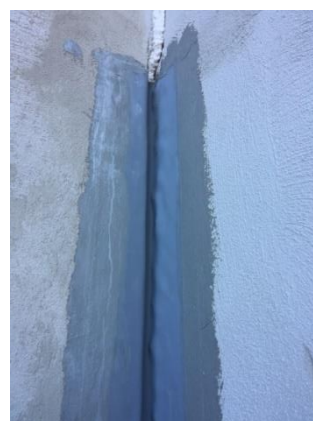
Figura 5.93 – Amostra de Impermeabilização na Junta de Dilatação Vertical Entre os Corpos [Data: 08.02.2017]
