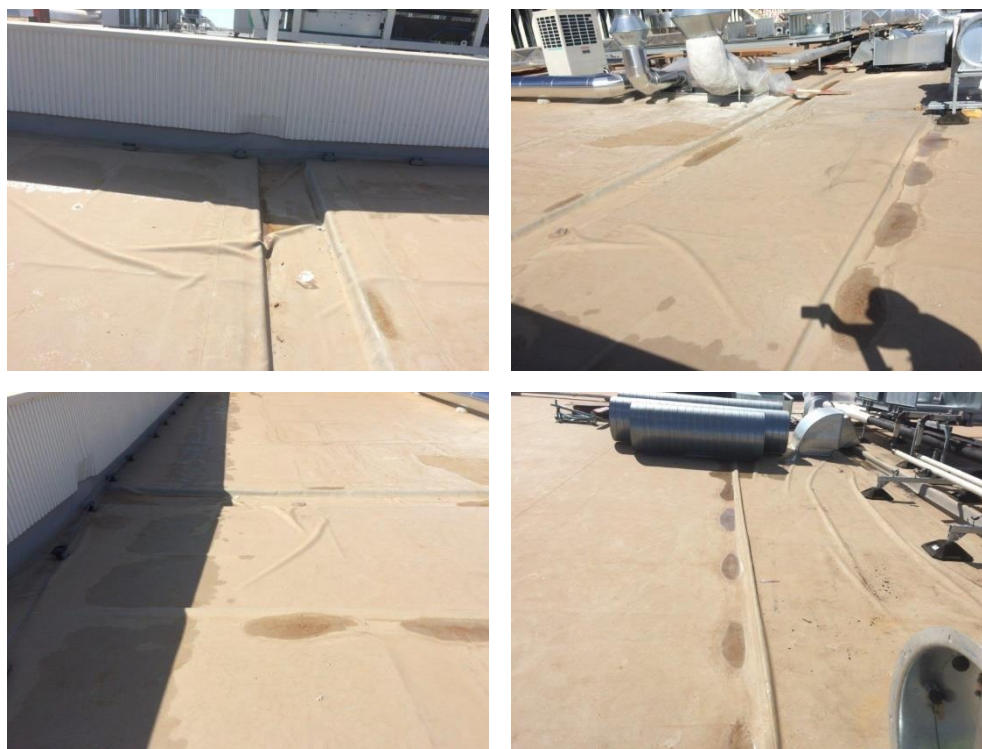
Figura 6.23 – Tela PVC danificada ao longo de toda a cobertura [Data: 29.08.2017]
