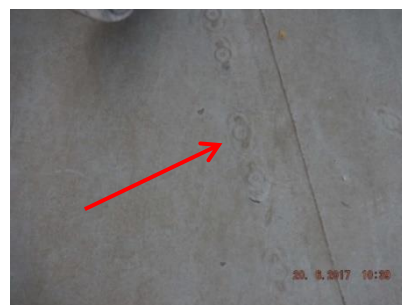
Figura 6.22 – Danos na Cobertura causados pelos carros de transporte [Data: 20.06.2017]
