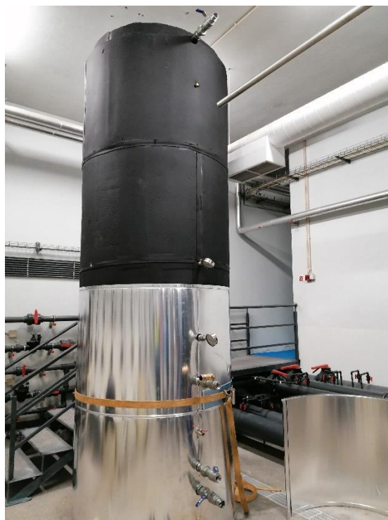
Figura 59: Fornecimento e montagem de depósito solar 5000L para AQS.
