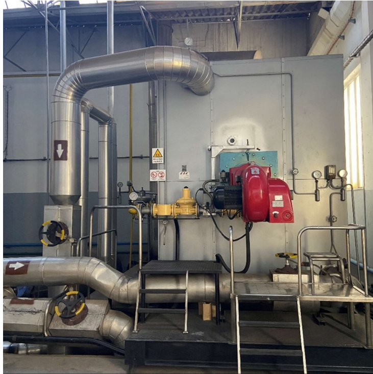
Figura 4.1. Exterior da caldeira a termofluido da Copo Têxtil.
