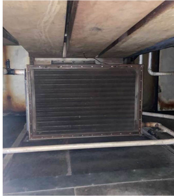
Figura 4.3. Radiador nº3 presente no interior da râmola 2.
