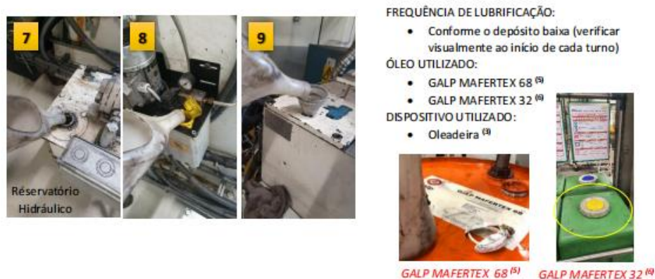
Figura 41- Depósitos de óleo
