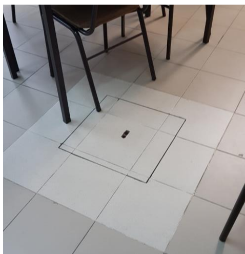
Figura 4.51 – Caixa de saneamento presente na sala de aula (Divisão A).
