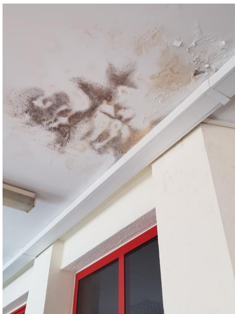
Figura 4.53 – Humidade no Piso 1.
