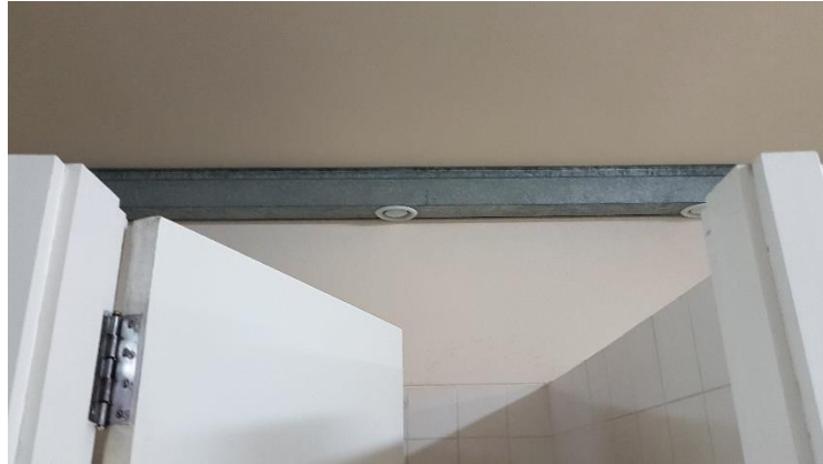
Figura 4.55 – Exemplo de sistema de ventilação, instalado noutra compartimento da escola.
