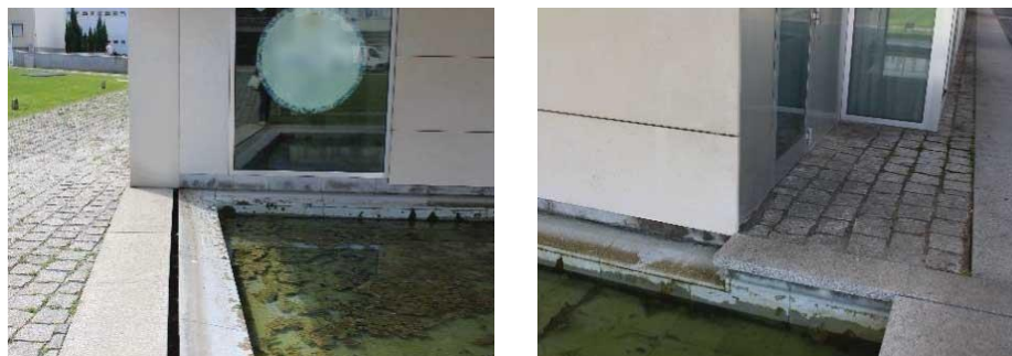
Figura 2.19 – Envolvente da caixa de escadas/junta de dilatação onde se verificam infiltrações.
