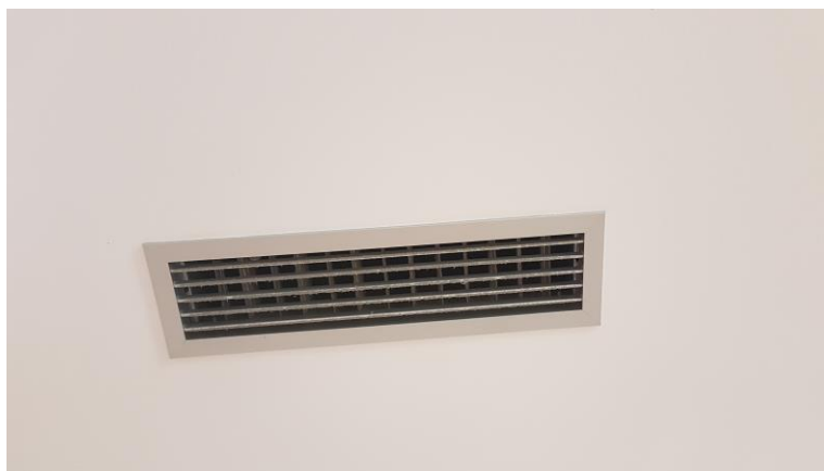
Figura 4.43 – Sistema de renovação do ar interior.
