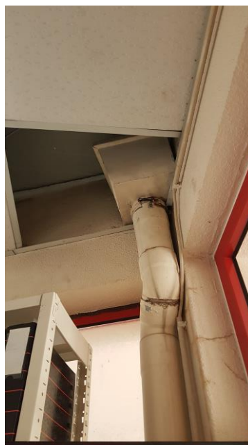
Figura 4.54 – Tubo de queda presente no interior do edifício.
