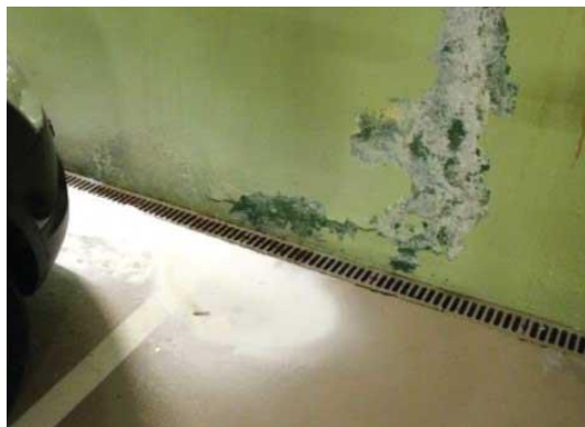
Figura 2.16 – Grelhas de drenagem periférica adjacentes às paredes do parque subterrâneo.
