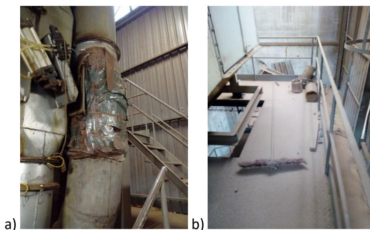
Figura 13 - Degradação das tubagens (a) e desorganização das ferramentas de trabalho (b)
