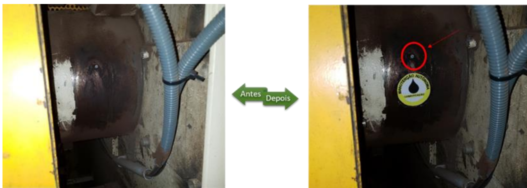
Figura 35 - Ponto de Lubrificação
