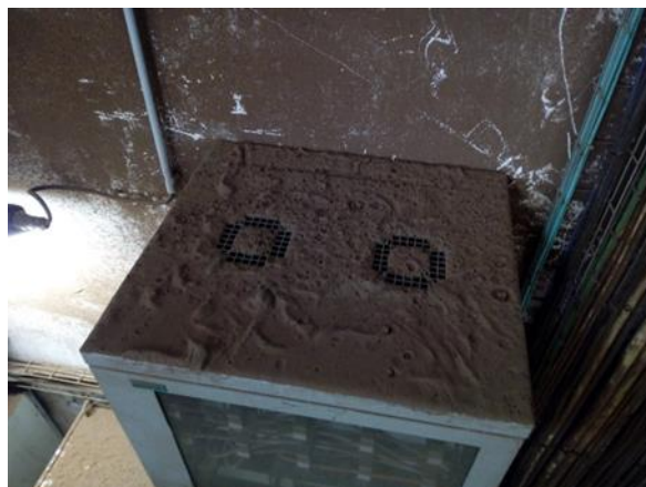
Figura 21 - Isolamento dos quadros elétricos
