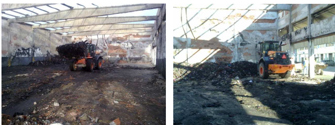
Imagem 73: Pá carregadora a remover os resíduos para contentor situado no exterior do mesmo.
