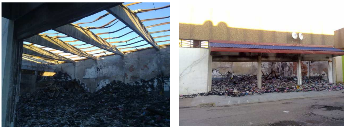
Imagem 71: Armazém após incêndio
