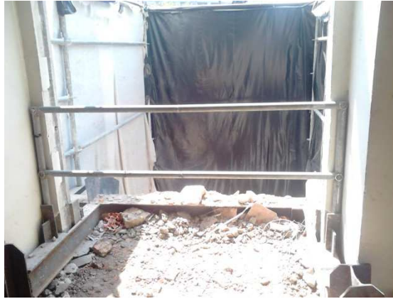
Imagem 16: Proteção de vão aberto
