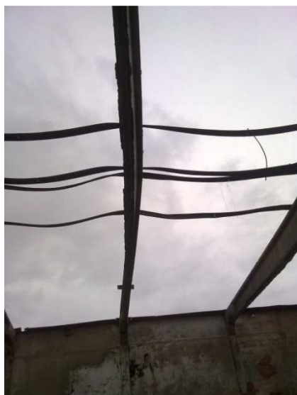
Imagem 72: Deformação das vigas delta consequente do incêndio
