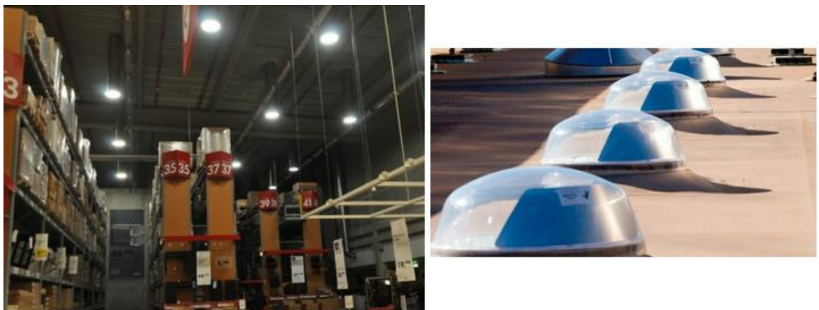
Figura 56 – Exemplo de instalação análoga, com armazém de duplo pé direito, solar tubes na cobertura e regulação de fluxo da iluminação artificial (0% do fluxo nominal na imagem)[58].
