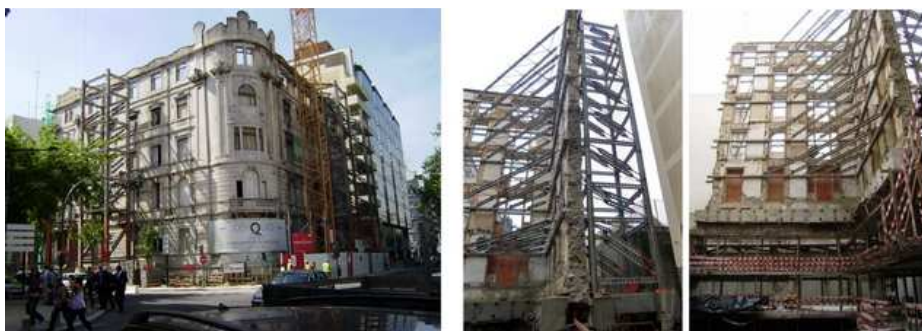
Figura 5.20: Exemplos de contenções de fachadas antigas [11]
