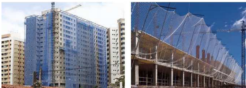
Figura 5.17: Redes de proteção contra quedas em altura [62]
