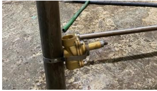
Figura 39 Fixação das Válvulas Solenoides às Bancadas de Ensaio
