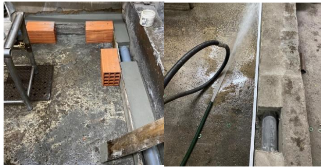
Figura 43 Escoamento de água
