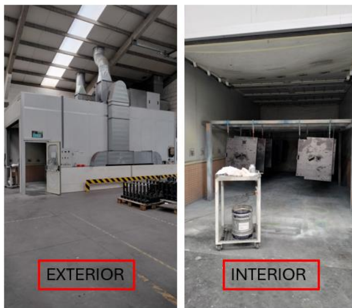
Figura 17 - Cabine de Pintura
