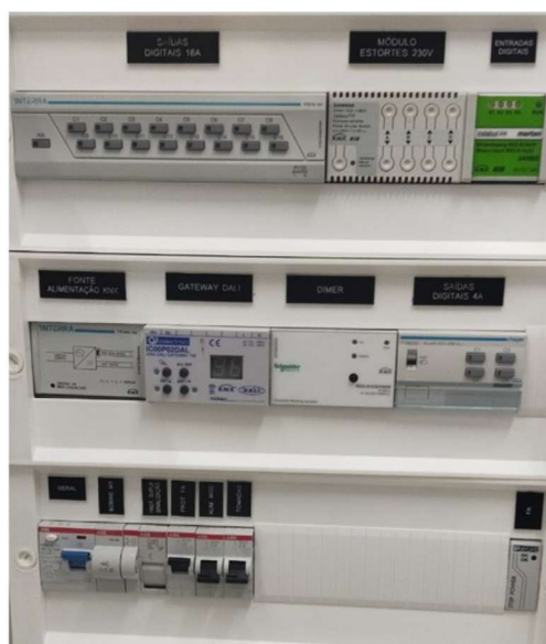
Figura 18 - Quadro Elétrico do painel KNX
