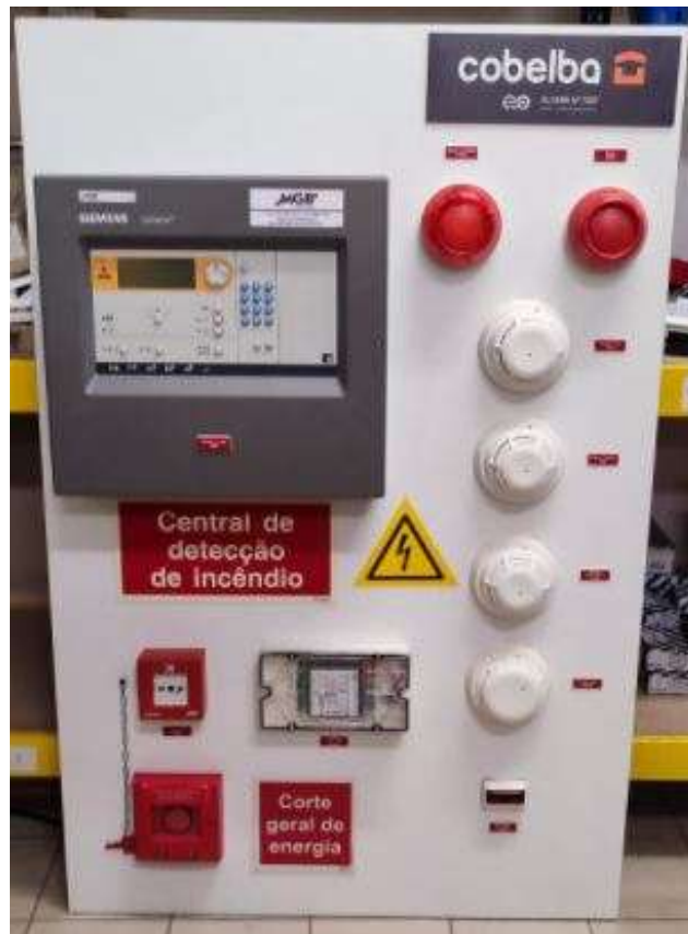
Figura 24 - Painel de Sistema Automático de Detecção de Incêndio
