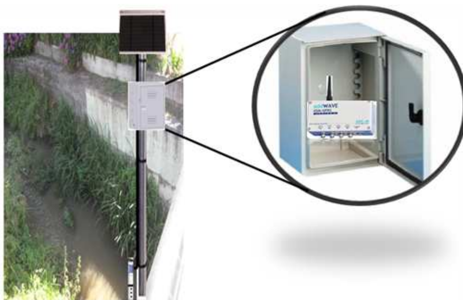
Figura 35 - Sistema de Vigilância e alerta instalado no rio Febros.
