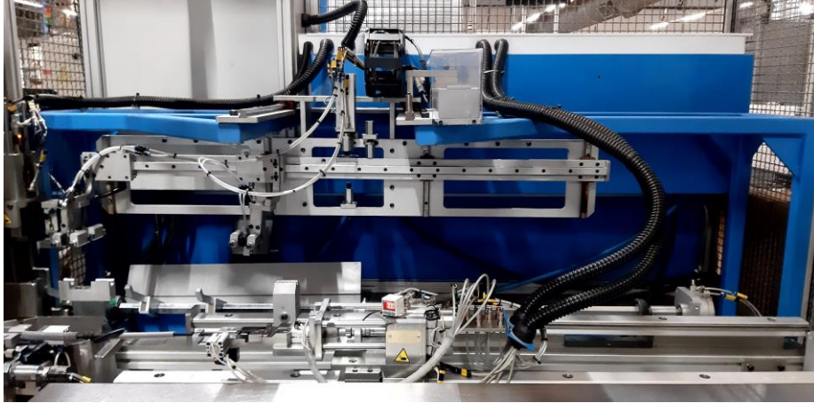
Figura 38 MCC instalado no Posto de ZAMAK.
