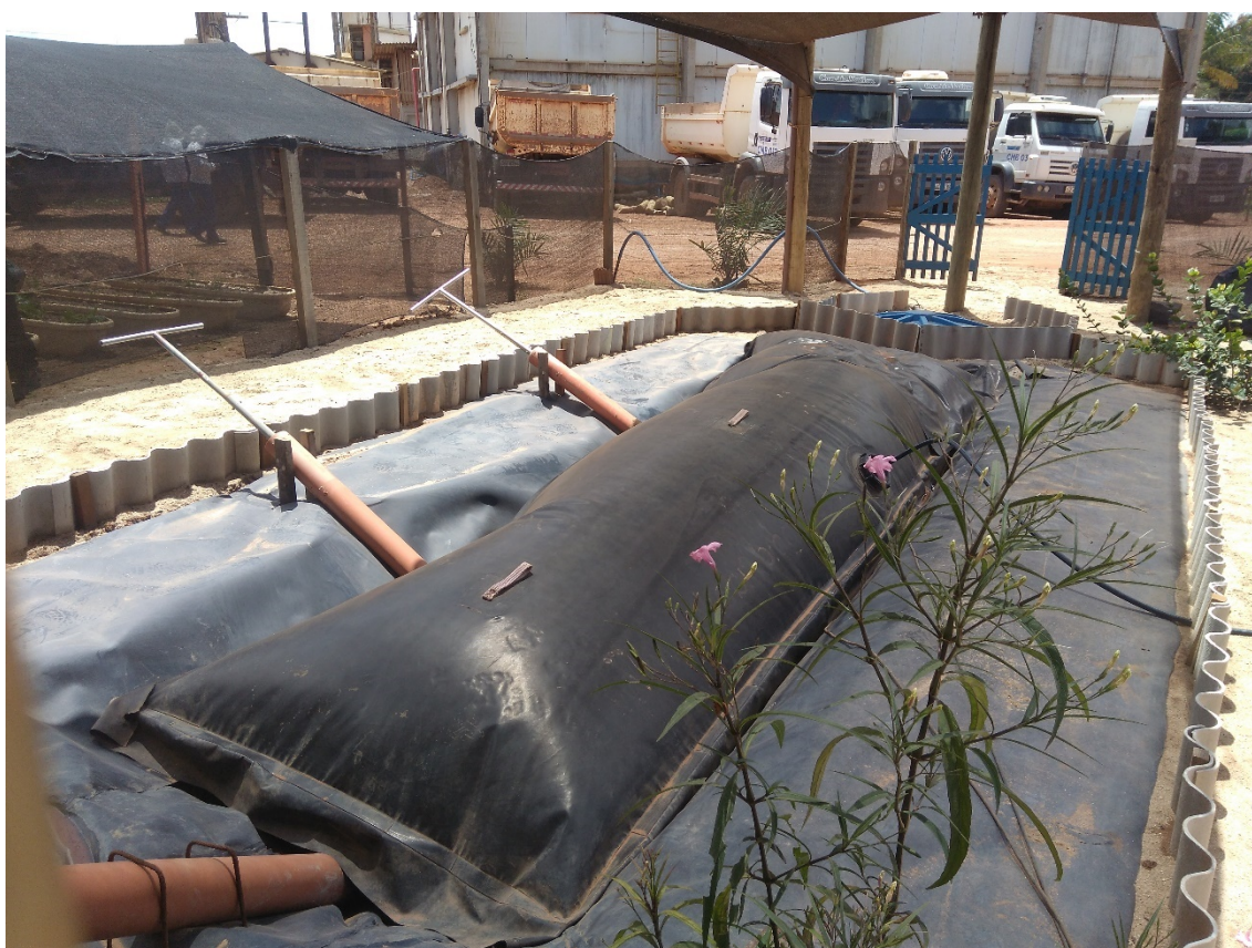
Figura 5: Biodigestor HoMethan instalado e em operação no Brasil, Fonte: Arquivo pessoal do autor.
