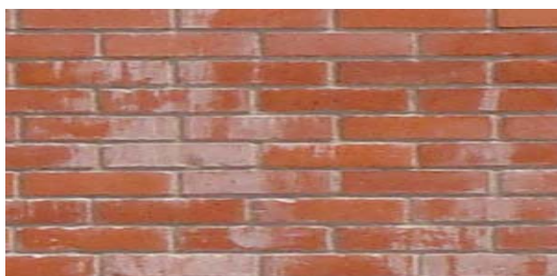
Figura 15 - Eflorescências no Cerâmico
