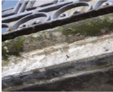
Figura 6 - Fachada de um edifício onde é visível eflourescências
