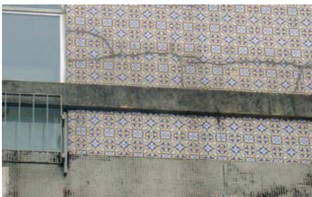
Figura 12 - Fissura no cerâmico
