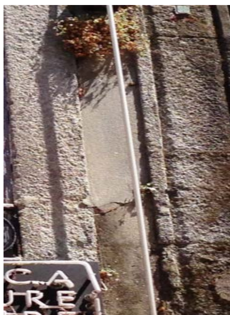
Figura 67 – Presença de vegetação / Alveolização
