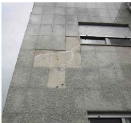
Figura 5 - Fachada de um edifício onde é visível o destacamento de várias placas de pedra (19)
