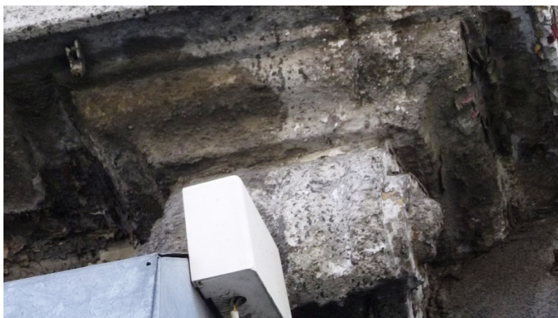
Figura 4- Fachada de um edifício na Rua do Loureiro onde é visível a desagregação granular
