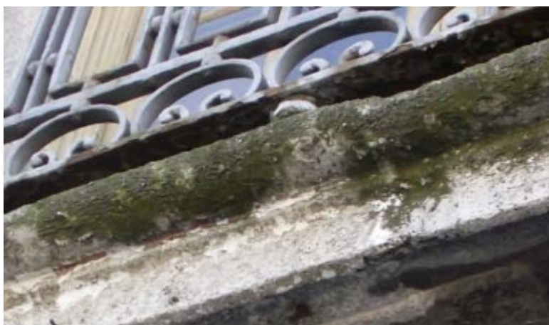
Figura 10 - Detalhe da fachada onde é possível ver a existência de colonização biológica
