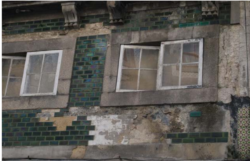
Figura 11 - Descolamento do cerâmico
