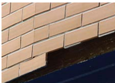
Figura 13 - Destacamento no cerâmico
