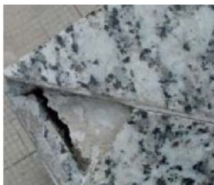
Figura 8- Detalhe da fachada onde é possível ver fissuração dos cantos de placas de pedra
