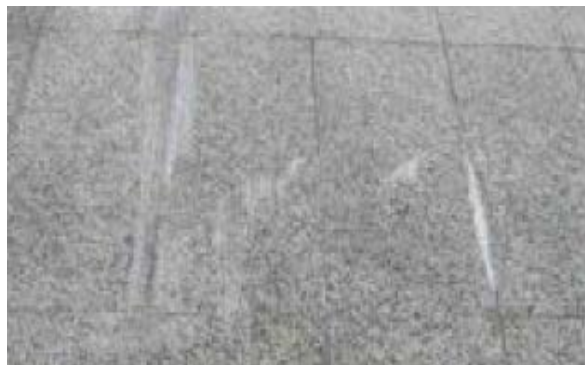
Figura 7- Fachada onde são visíveis eflourescências com maior intensidade nas juntas entre pedras
