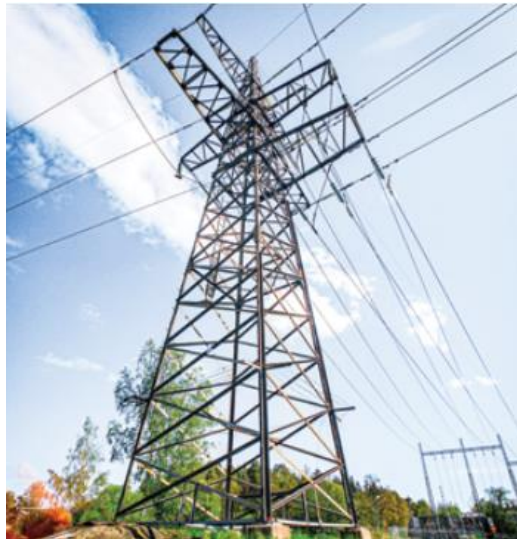
Figura 6 - Torre de Derivação [26]
